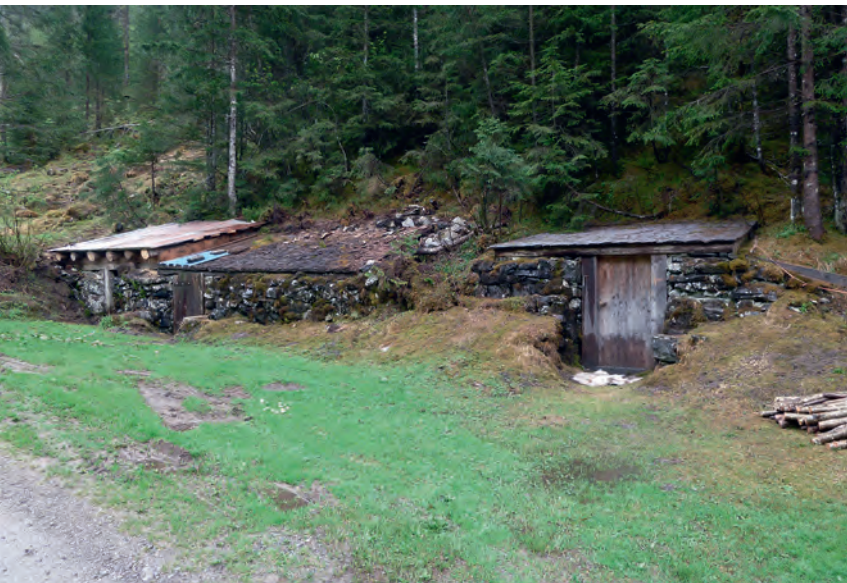
Abb. 158 Die Kühlkeller im Schächental im Kanton Uri liegen stark eingetieft am Fuss eines Schattenhangs. Blick nach Süden.
