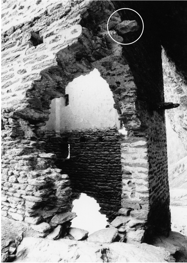
Abb. 36 Marmorera, Buranlage Marmels. Ausgebrochene Nordwestecke der Kapelle. Ein herausragender Stein markiert jene Höhe, bis zu welcher die Westmauer von Gebäude 2 mit der Kapelle im Verband gestanden hat. Vom einstigen Kapellenwesteingang sind Teile der Schwelle sowie die südliche Türleibung erhalten geblieben. Blick nach Südosten.
