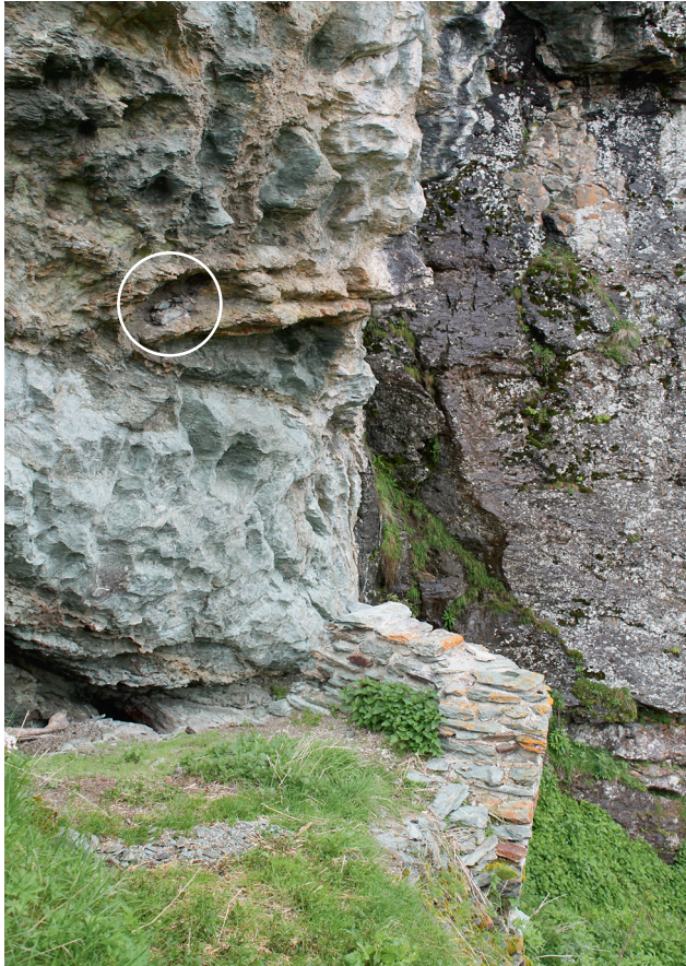
Abb. 74 Marmorera, Burganlage Marmels. Nordwestecke von Gebäude 3 im Jahre 2011. Letzte Reste der Nordmauer fanden sich hoch oben im Felsen westlich von Gebäude 2. Blick nach Nordwesten.
