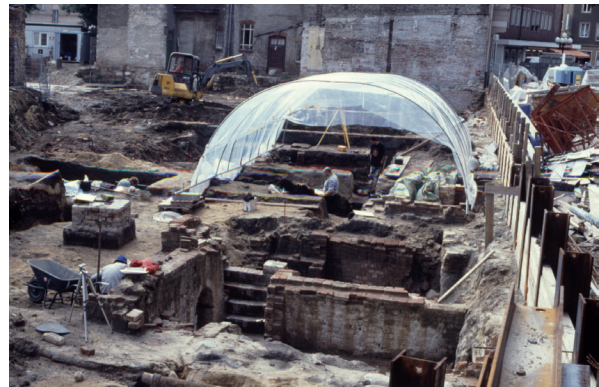
Abb. 19 Zeltkonstruktion über dem Keller 130 mit dem englische Grabungstechniker Niaill Robertson (links) und dem Helfer Alejandro Soto-Roco (hinten). Rechts ist der Verbau unmittelbar an der Schlosskirchstraße erkennbar, Blick von Ost-südost.
