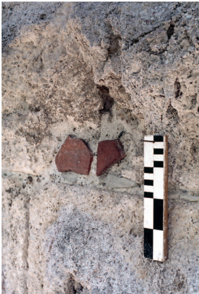
Abb. 90 Kastelen LU. Südfassade, 2. Obergeschoss. Bauzeitlich geflickte Fehlstelle in einem Eckquader mit flach in den Mörtel eingedrückten Ziegelbruchstücken (Südwestecke, 665,20 m ü. M.). Blick von Südosten.
