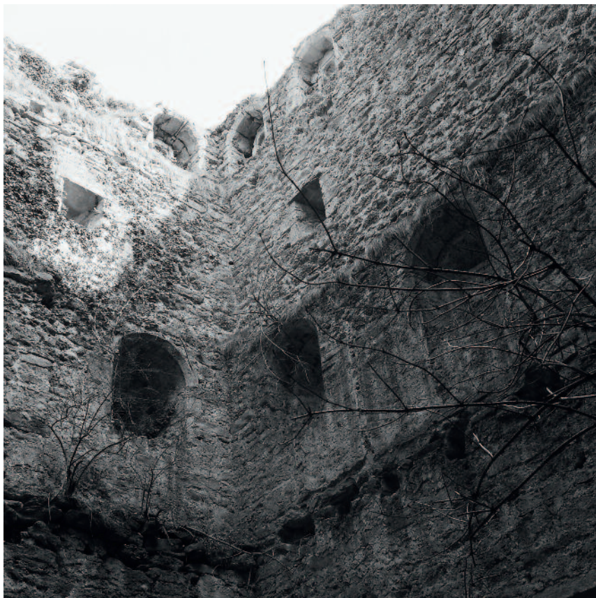
Abb. 221 Kastelen LU. Innenansicht der Südostecke. Die rundbogigen Fenster­nischen im 1. Obergeschoss zeigen den Standort der Kapelle an, jene im 3. Obergeschoss den Standort der Stube. Aufnahme aus den 1960er-Jahren (Hans Marti). Blick gegen Südosten.
