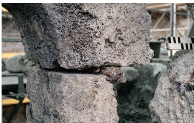
Abb. 133 Kastelen LU. Ostfassade, 3. Obergeschoss. Hölzerner Dübel beim Gewände des Rundbogenfensters Pos. 2403. Das Holzstück steckte ursprünglich in einer heute fast vollständig weggebrochenen Vertiefung. An seinem linken Rand sind die Reste der eisernen Angel für einen Fensterladen zu erkennen. Blick von Südosten.
