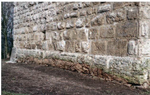
Abb. 80 Kastelen LU. Südfassade. Der aus zwei Steinlagen bestehende, vorspringende und stark verwitterte Turmsockel. Im angeschrägten Teil der oberen Steinlage sind die Quader mit einer wulstartigen Leiste versehen. Blick von Südosten.
