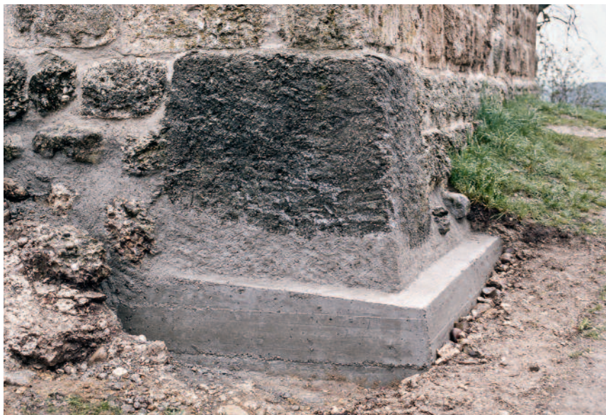
Abb. 300 Kastelen LU. Durch einen Zementflick der Zeit nach 1912 gesicherte Südwestecke des Wohnturms mit ergänzter Unterfangung. Zustand unmittelbar nach der Sanierung 2001.
