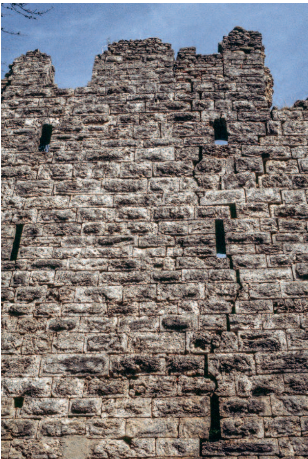
Abb. 212 Kastelen LU. Westfassade. Als Folge von Setzungen in der Nordwestecke hervorgerufene, senkrecht verlaufende Risse. Blick von Westen.
