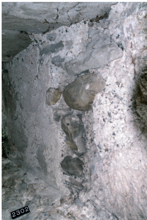
Abb. 95 Kastelen LU. Innenseite Ost, 2. Obergeschoss. Deckender Verputz an den Leibungen und auf der Bank der Fenster niche Pos. 2302. Blick gegen Südosten.
