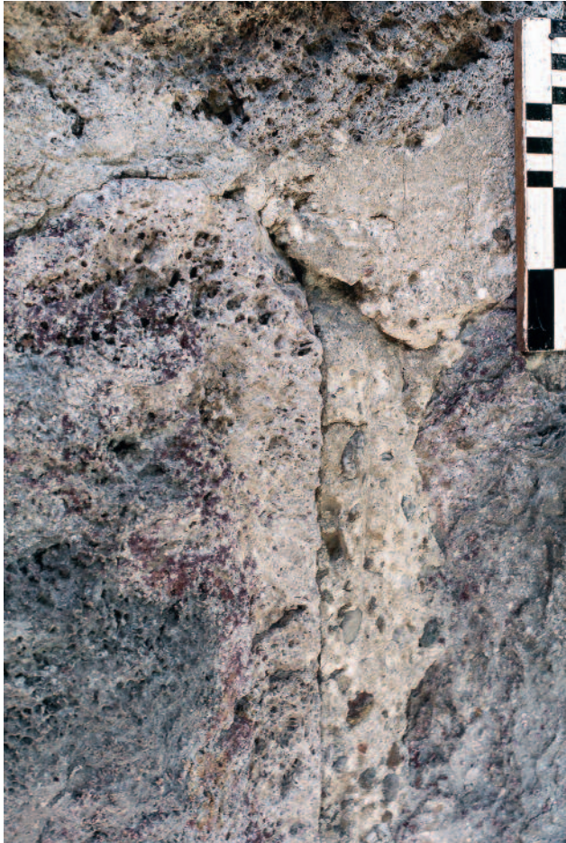
Abb. 92 Kastelen LU. Südfassade. Oberflächlich abgewitterter, grobkörniger Fugenmörtel mit Spuren eines senkrechten Fugenstrichs. Der Quader links ist Bestandteil des Fenstergewändes zu Pos. 3202. Blick von Südwesten.
