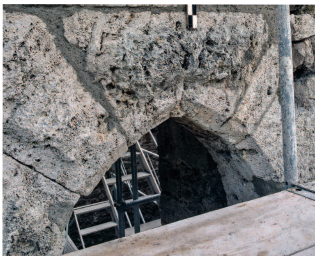
Abb. 166 Kastelen LU. Westfassade, 1. Obergeschoss. Hocheingang Pos. 4202. Die Mörtelreste an der Bogenspitze des Hocheingangs stammen von der Zumauerung der Türöffnung nach der Aufgabe des Wohnturms 1743. Blick von Nordwesten.
