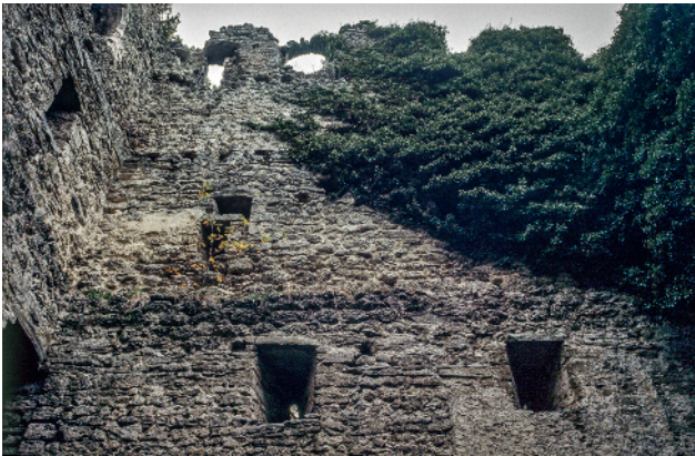
Abb. 13 Kastelen LU. Innenseite Nord. Zustand vor der Restaurierung, 1992. Blick gegen Norden.
