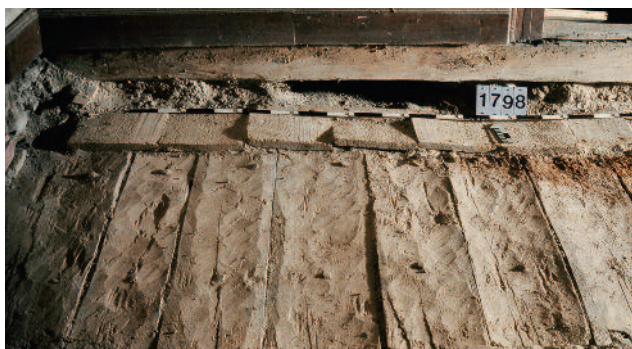
Abb. 214 Diessenhofen TG, Unterhof. Originale Bodenkonstruktion der Zeit um 1278. Die nur grob bearbeiteten Bohlen wurden mit Holznägeln an der Balkenlage befestigt und mit einem Mörtelestrich überdeckt.
