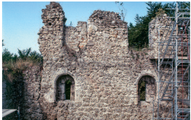
Abb. 86 Kastelen LU. Innenseite West. Fast ausschliesslich aus Nagelfluhbrocken aufgeführter innerer Mauer­mantel auf der Höhe des 3. und 4. Obergeschosses. Blick gegen Westen.
