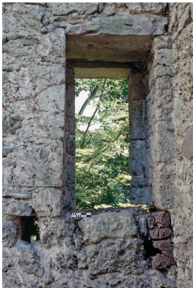
Abb. 170 Kastelen LU. Innenseite Nord, 2. Obergeschoss. Abortaustritt Pos. 1304. Unterhalb der Schwelle sind die Balkenenden der Erkerkonsolen sichtbar (Pos. 1322, 1323). Blick gegen Norden.
