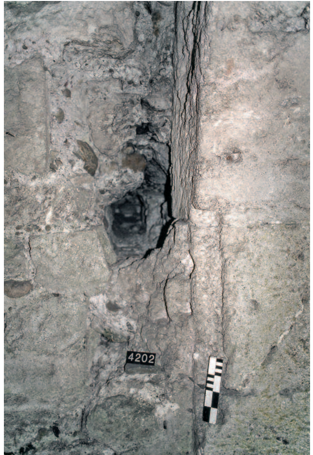
Abb. 165 Kastelen LU. Westseite, 1. Obergeschoss. Hocheingang Pos. 4202. Beschädigter Sperrbalkenkanal in der südlichen Leibung. Der Masstab steht in der Aussparung, die bei einer Reparatur des Türschlosses ausgehauen werden musste. Blick gegen Süden.
