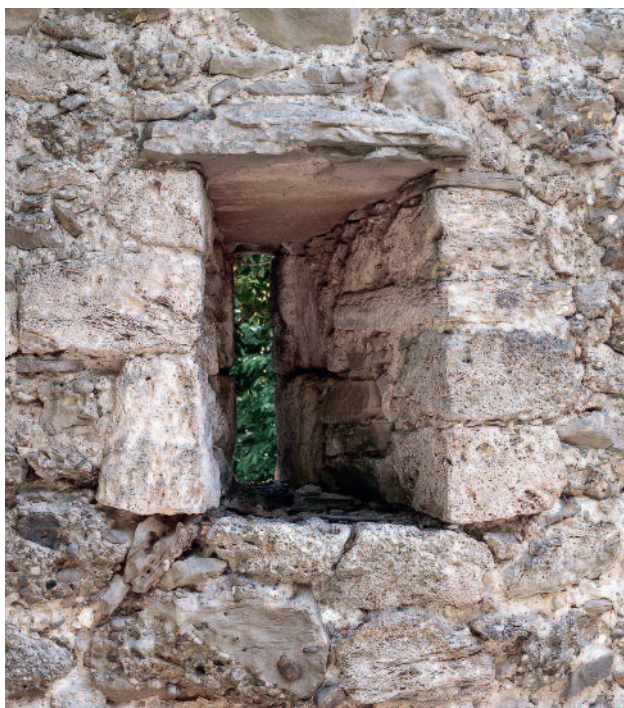
Abb. 103 Kastelen LU. Innenseite Süd, 2. Obergeschoss. Lichtscharte mit geradem Sturz: Öffnung Pos. 3301. Blick gegen Süden.
