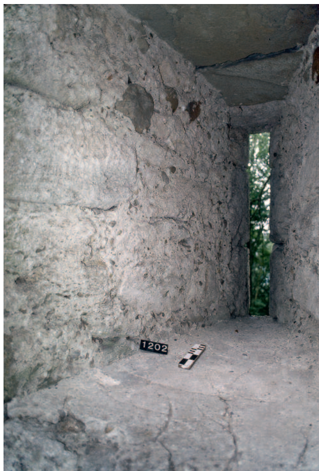
Abb. 94 Kastelen LU. Innenseite Nord, Lichtscharte Pos. 1202 im 1. Obergeschoss. Der in der späteren Nutzungszeit des Wohnturms erneuerte Mörtelstrich auf der Fensterbank schliesst nahtlos an die Mauerfläche der Leibung an. Der bauzeitliche Pietra-rasa-Verputz dieser Fläche ist weitgehend verwittert. Blick gegen Nordwesten.
