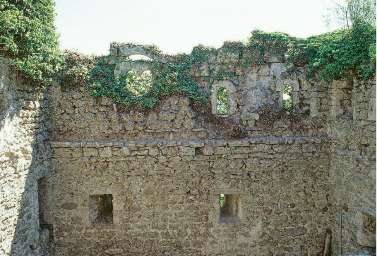
Abb. 111 Kastelen LU. Innenseite Ost, 2. und 3. Obergeschoss. Zustand während der Freilegung 1998. Die Fensternischen im 3. Obergeschoss sind bereits stark zerfallen. Auf der Höhe der Fensterstürze im unteren Stockwerk sind drei Gerüsthebellöcher vorhanden. Blick gegen Osten.
