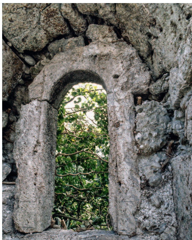
Abb. 130 Kastelen LU. Innenseite Süd, 3. Obergeschoss. Rundbogenfenster Pos. 3401 mit sorgfältig gefertigtem Fensterfalz. Am rechten Fensterposten sind Dübellöcher zur Verankerung des Fensterflügels angebracht.
