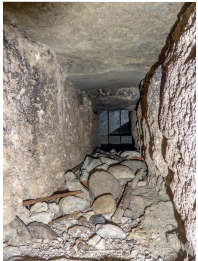
Abb. 141 Kastelen LU. Westseite, Erdgeschoss. Blick von aussen in den Kanal Pos. 4105. Der sauber gefügte Kanal besitzt Wägen aus Tuffstein und eine Abdeckung aus Sandsteinplatten. Blick von Westen.
