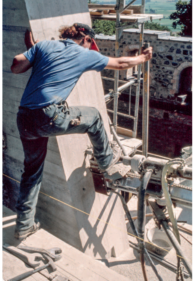
Abb. 336 Kastelen LU. Westseite, 4. Obergeschoss. Bohrarbeiten für das Einsetzen eines Zugankers in den Mauerkern beim betonierten Stützkeil über der Südwestecke. Blick von Südwesten.
