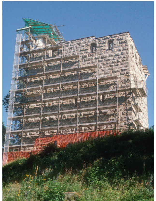
Abb. 332 Kastelen LU. Bereits teilweise abgebautes Gerüst an der Südfassade, Blick von Südosten.
