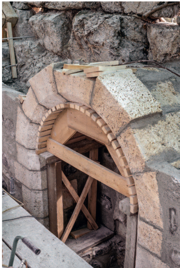
Abb. 338 Kastelen LU. Innenseite Ost, 3. Obergeschoss. Aus zugesägten Tuffsteinblöcken rekonstruierte Fensternische des Sitznischenfensters Pos. 3402, mit Lehrgerüst. Blick gegen Nordosten.
