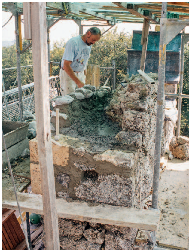
Abb. 331 Kastelen LU. Josef Wermelinger, Alberswil, beim Aufmauern des inneren Mauermantels an der Westseite des Wohnturms.
