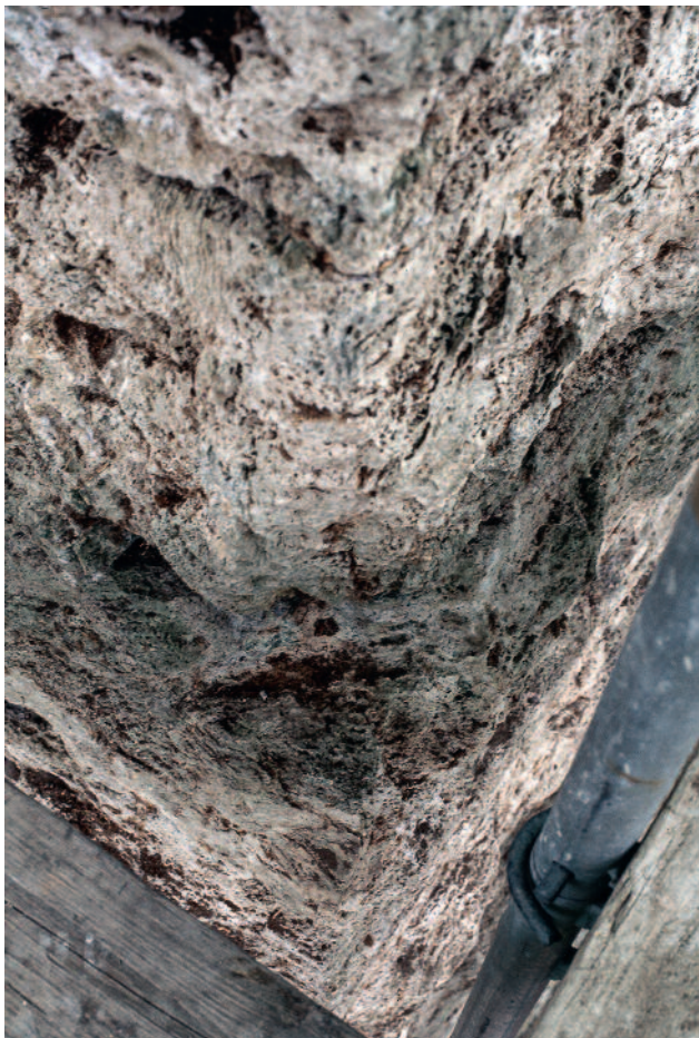
Abb. 189 Kastelen LU. Nordostecke, 3. Obergeschoss. Keilförmig aus der Fassade gehauenes Auflager Pos. 5405 für die Stützstrebe des um 1605 erneuerten nordöstlichen Erkers. Blick von Nordosten.
