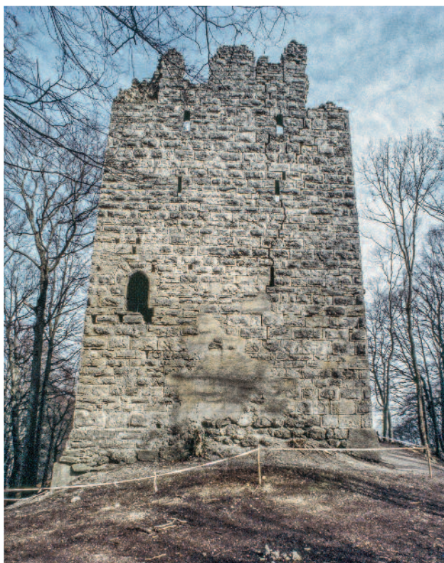
Abb. 153 Kastelen LU. Westfassade, Zustand vor der Restaurierung. Das Mauerwerk weist einen durchgehenden Längsriss auf. Die Verputzfläche im Bereich des Erdgeschosses (Pos. 4115) bedeckt die Ansatzstelle der abgebrochenen Steintreppe zum Hocheingang. Blick von Westen.
