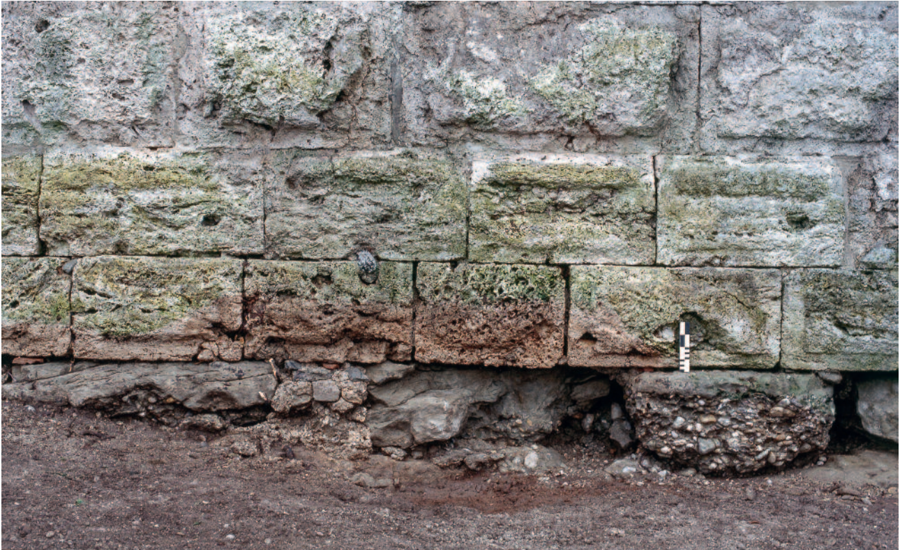
Abb. 211 Kastelen LU. Ostfassade, Erdgeschoss. Flickstellen im Fundament- und Sockelbereich (hier links) zeugen von der fortgeschrittenen Erosion am Turmfuss bereits in der frühen Neuzeit. Blick von Osten.
