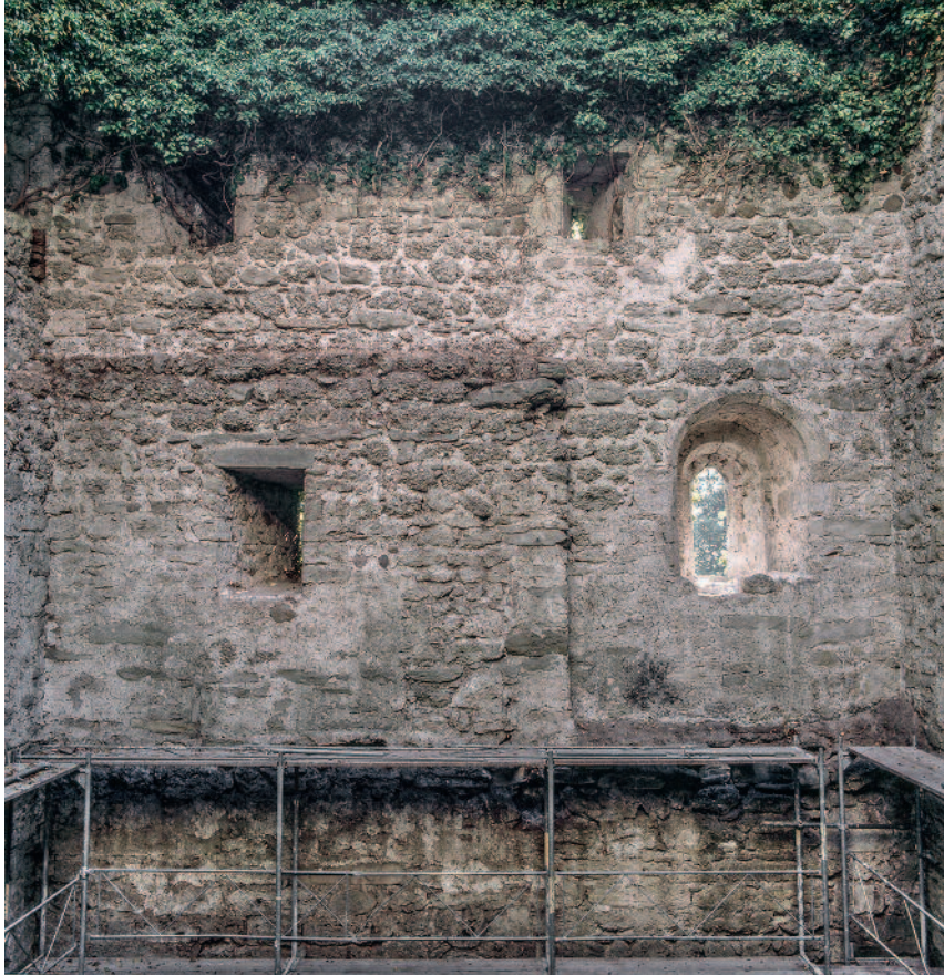
Abb. 222 Kastelen LU. Innenseite Ost. Das 1. Obergeschoss ist geprägt durch den Mauerrücksprung und das Rundbogenfenster Pos. 2202 im südöstlichen Raum (Kapelle). Im 2. Obergeschoss sind beim Fenster Pos. 2302 Reste eines deckenden Putzes feststellbar (Pos. 2307).
