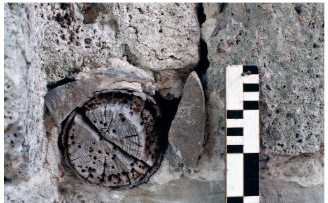
Abb. 173 Kastelen LU. Nordseite, 2. Obergeschoss. Abortaustritt Pos. 1304. Eingemauertes Rundholz im unteren Teil der östlichen Leibung, welches wohl als Dübel zur Verankerung eines Türklobens vorgesehen war. Blick gegen Osten.
