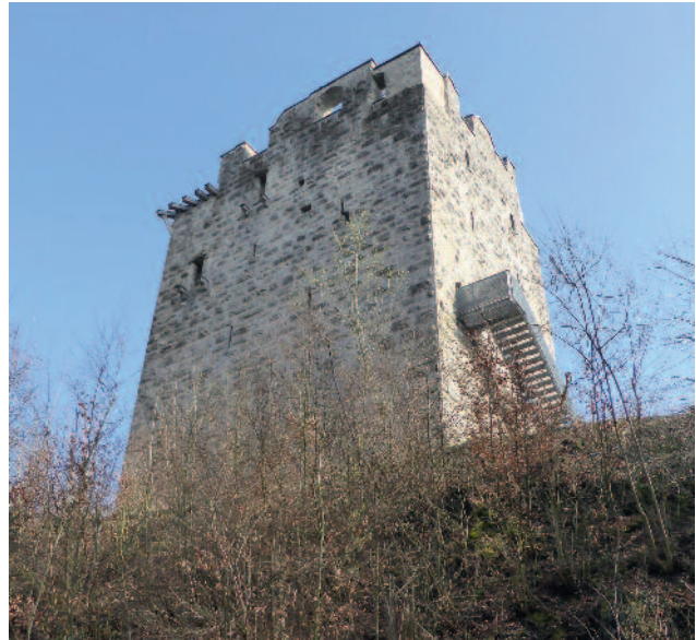
Abb. 74 Kastelen LU. Blick von der umlaufenden Burgterrasse auf die geschlossen erscheinende Nordseite und die durch den Hocheingang ausgezeichnete Westseite. Zustand 2016, Blick von Nordwesten.
