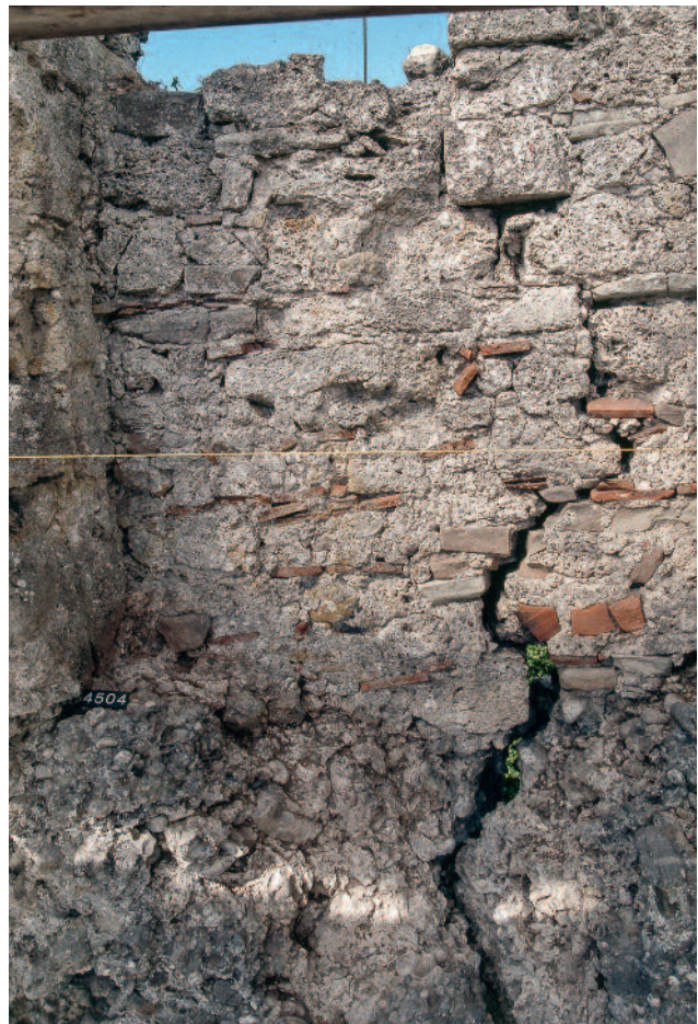
Abb. 213 Kastelen LU. Innenseite West, 4. Obergeschoss. Wegen der Setzungen im Mauerwerk ist auch die nachträgliche Vermauerung der Öffnung Pos. 4501 gerissen. Blick gegen Westen.
