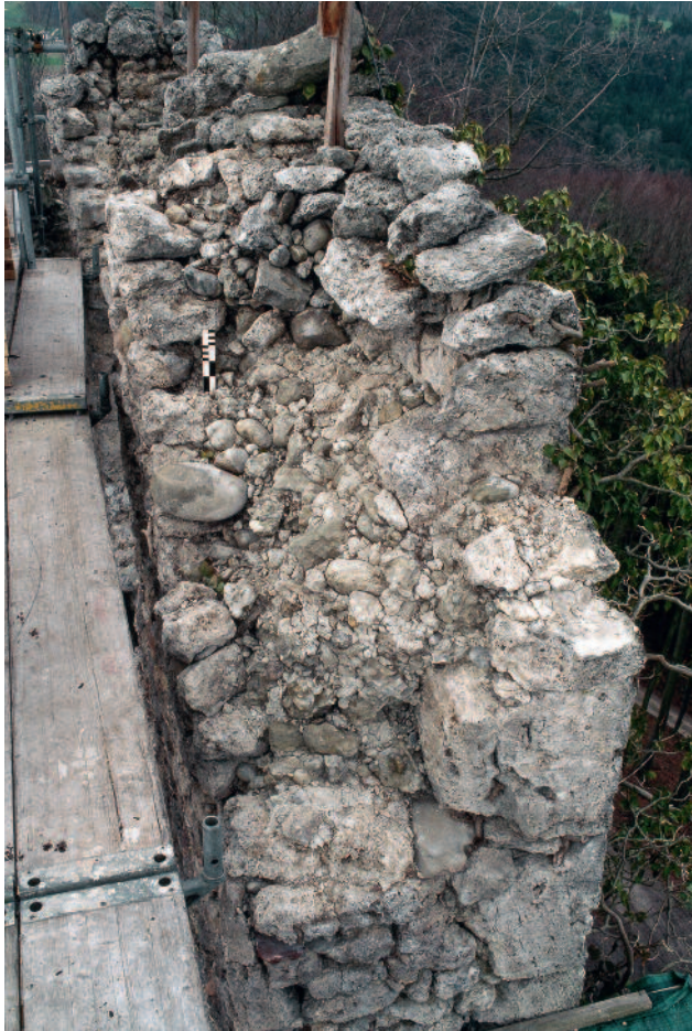
Abb. 88 Kastelen LU. Nordseite, Mauerkrone. Freiliegender Mauerkern im Abschnitt zwischen den Öffnungen Pos. 1503 (vorne) und 1502. Blick gegen Westen.
