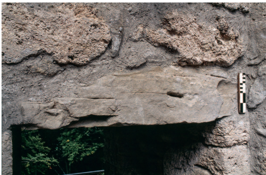
Abb. 202 Kastelen LU. Innenseite Nord, 2. Obergeschoss. Türsturz des Abortaustritts Pos. 1304. Am Sturz eine im Steinbruch vorbereitete Keiltasche zur Herstellung von Sandsteinplatten. Blick gegen Nordosten.
