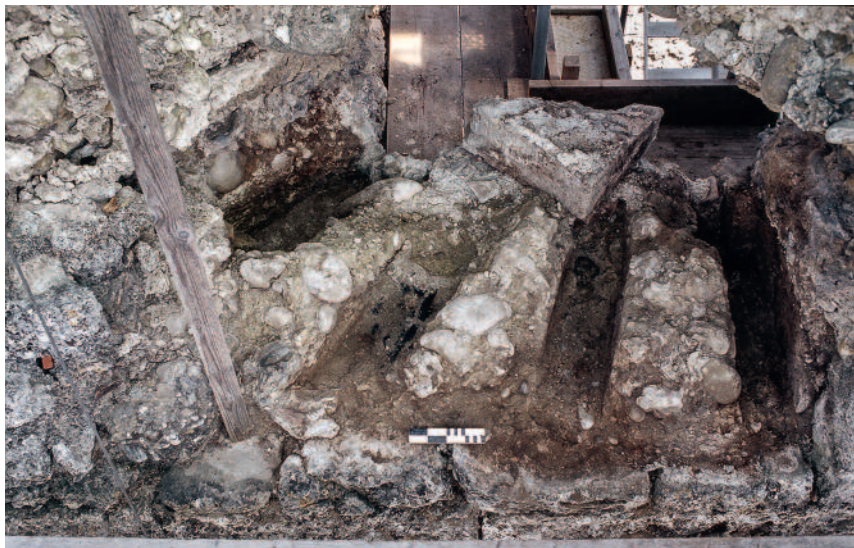
Abb. 181 Kastelen LU. Nordwestecke, 4. Obergeschoss. Blick von aussen auf die Negative der fächerförmig angeordneten Erkerkonsolen im Mauerausbruch Pos. 4403 (Pos. 1426, 4407–4409). Die ausgebrannten Balkenöffnungen sind zugemauert, als Teil des Mauerflicks ist auch eine dreieckige Spolie zu erkennen. Blick von Westen.
