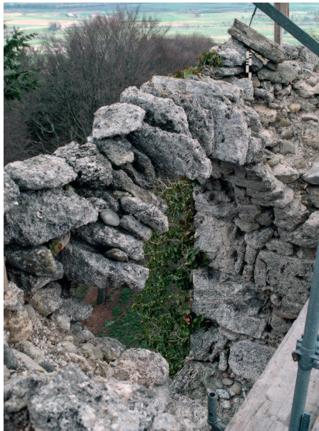
Abb. 123 Kastelen LU. Innenseite Nord, 4. Obergeschoss. Rundbogenöffnung Pos. 1502. Reste des Gewölbes und östliche Leibung. Blick gegen Nordosten.
