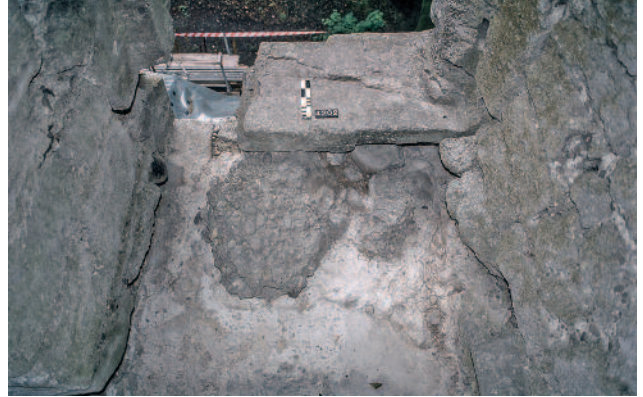
Abb. 163 Kastelen LU. Westseite, 1. Obergeschoss. Hocheingang Pos. 4202. Blick von innen auf die stark in Mitleidenschaft gezogene, am Südende ausgebrochene Schwelle des Hocheingangs. Das eigentliche Bodenniveau ist im Durchgang nicht mehr erhalten. Blick gegen Westen.
