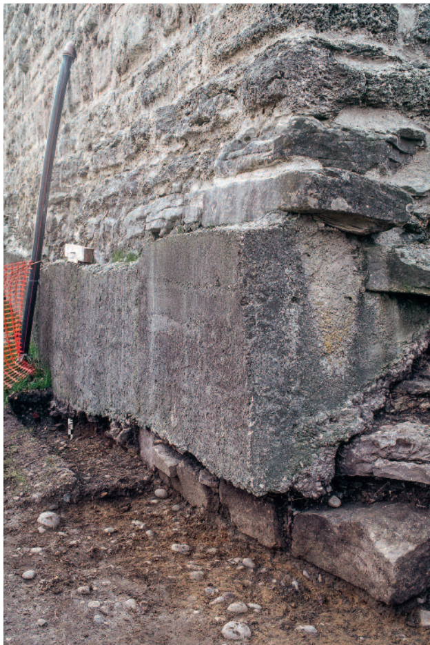
Abb. 290 Kastelen LU. Nordfassade. Betonplombe der Zeit nach 1912 im keilförmigen Ausbruch des Fundaments. Das Fundament lag hier bereits in der frühen Neuzeit frei. Blick von Nordwesten.
