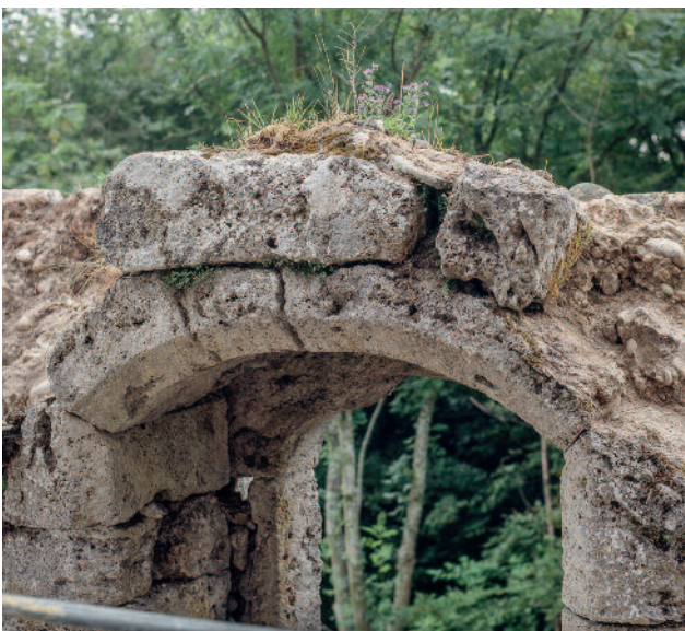
Abb. 117 Kastelen LU. Innenseite Süd, 3. Obergeschoss. Doppelfenster Pos. 3403. Detail der aus Tuffsteinplatten gefügten stichbogigen Fensternische. Blick gegen Südosten.
