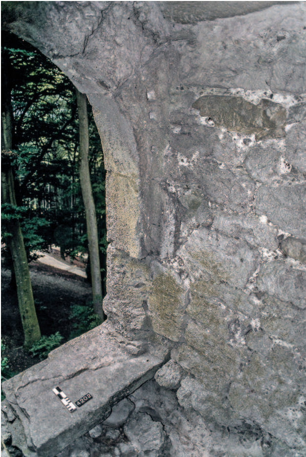
Abb. 164 Kastelen LU. Westseite, 1. Obergeschoss. Hocheingang Pos. 4202. Blick von innen an den nördlichen Türanschlag. Zahlreiche Angellöcher weisen auf mehrfache Reparaturen hin. Die Rast für den Sperrbalken ist lediglich noch als unförmiger Ausbruch zu erkennen. Blick gegen Nordwesten.
