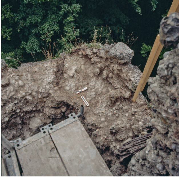
Abb. 187 Kastelen LU. Südwestecke, 4. Obergeschoss. Mauerkrone mit Spuren der fächerförmig angeordneten Erkerkonsolen. An der äusseren Mauerschale sind Reste der jüngeren Vermauerung (Pos. 5407) erhalten, mit welcher die Balkenlöcher nach Abbruch des Erkers verschlossen worden sind. Unten rechts Balkenrest Pos. 4406. Blick gegen Südwesten.
