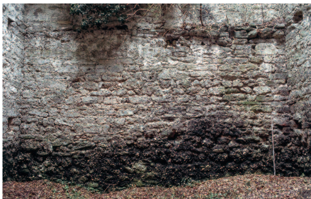
Abb. 85 Kastelen LU. Innenseite Ost, Erdgeschoss. Das Mauer­gefüge besteht im Sockelbereich mehrheitlich aus unregelmässigen Nagelfluhbrocken, darüber aus Sandsteinen und behauenen Tuffsteinen. Blick gegen Osten.
