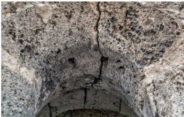
Abb. 241 Kastelen LU. Ostfassade, 1. Obergeschoss. Rundbogen des Kapellenfensters Pos. 2202 mit nachträglich ausgespitzten Löchern für zwei senkrecht eingesetzte Eisenstäbe. Untersicht/Blick von Osten.
