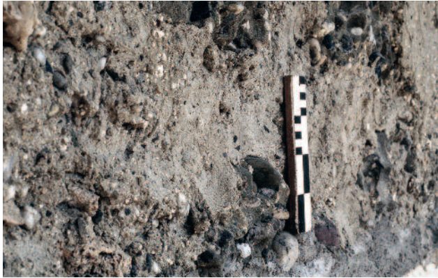
Abb. 96 Kastelen LU. Innenseite Nord, 3. Obergeschoss. «Maurerknie» östlich des Abortaustrittes Pos. 1402: Knieabdrücke eines mittelalterlichen Handwerkers im Fugenmörtel, mit Textilnegativ des Kleidungsstücks. Blick gegen Nordosten.
