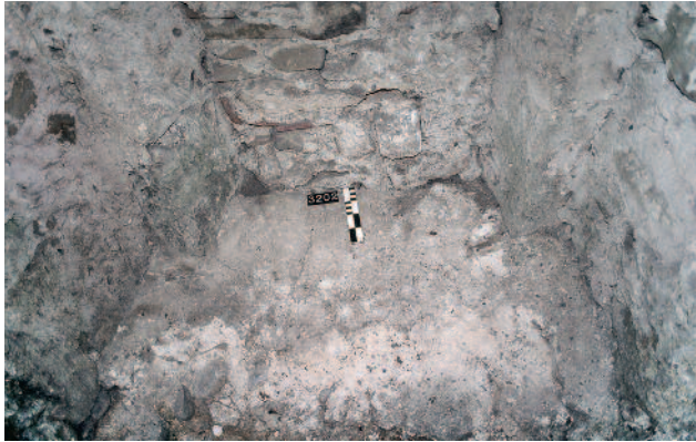
Abb. 246 Kastelen LU. Innenseite Süd, 1. Obergeschoss. Fenster niche zu Pos. 3202. Die Fensterbank wurde nach der Vermauerung des Fensters (Hintergrund) mit einem Mörtelguss versehen.
