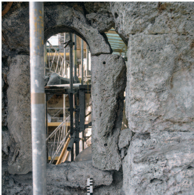
Abb. 132 Kastelen LU. Südfassade, 3. Obergeschoss. Rundbogenfenster Pos. 3401. Der östliche Fensterposten trägt an der Aussenseite Dübellöcher zur Anbringung eines Fensterladens. Blick von Süden.
