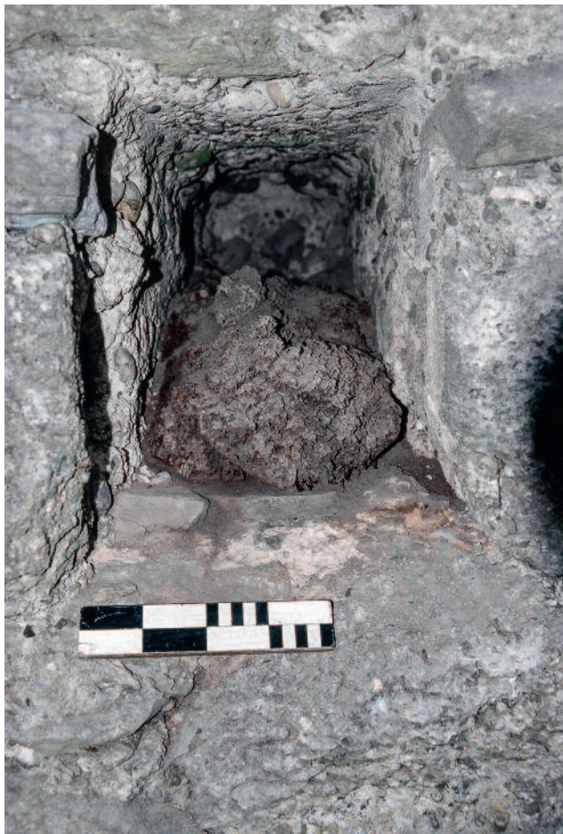
Abb. 145 Kastelen LU. Innenseite Nord. Bodenbalkenlage zum 1. Obergeschoss: letzter Rest eines Balkens im Balkenloch Pos. 1110. Blick gegen Norden.
