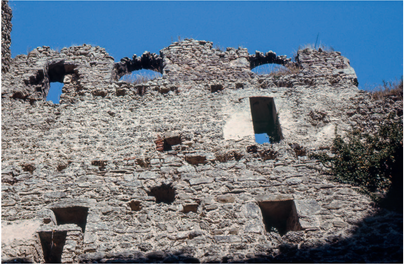
Abb. 100 Kastelen LU. Innenseite Nord, 2. bis 4. Obergeschoss. Historische Aufnahme aus den 1970er-Jahren (Hans Marti): Bei der Rundbogenöffnung Pos. 1503 im 4. Obergeschoss (rechts) sind noch Reste des Gewölbes erhalten. Blick gegen Norden.
