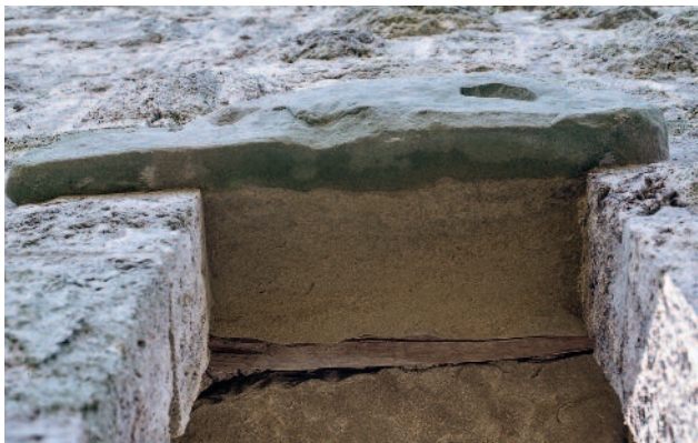
Abb. 172 Kastelen LU. Nordfassade, 2. Obergeschoss. Vorkragender Sturzstein über dem Austritt Pos. 1304. Die Spalte zwischen zwei Sturzplatten über dem Durchgang ist mit einer hölzernen Leiste geschlossen. Untersicht/Blick von Norden.
