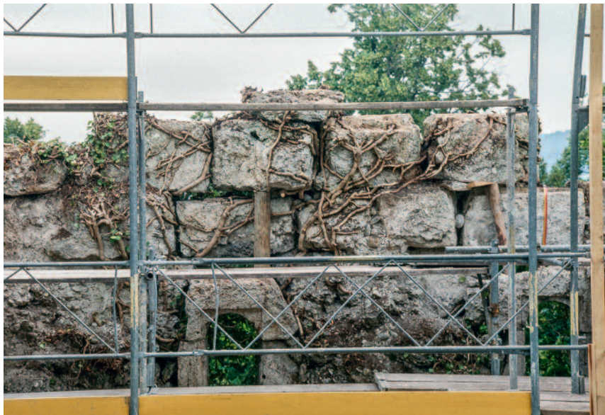
Abb. 79 Kastelen LU. Innenseite Ost, 3. Obergeschoss. Blick auf die freiliegenden Rückseiten der Tuffsteinquader des äusseren Mauermantels, oberhalb der Rundbogenfenster Pos. 2402 und 2403. Die innere Mauerschale und der Mauerkern sind hier vollständig wegerodiert, die für die Zerstörung mitverantwortlichen Efeuranken halten die Quader noch einigermaßen zusammen. Es ist gut zu erkennen, dass die einzelnen Quader gegen hinten an allen vier Seitenflächen leicht konisch zugerichtet sind. Blick gegen Osten.
