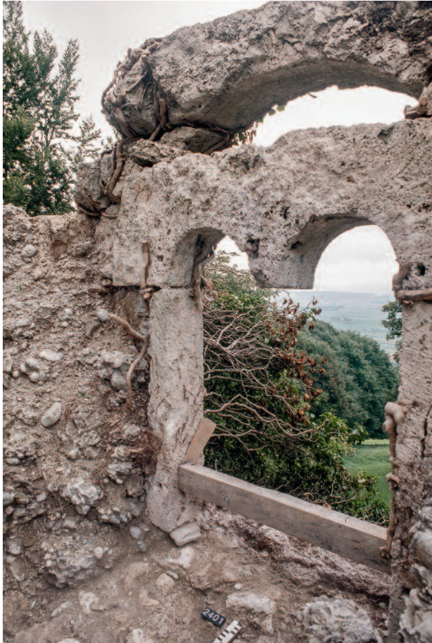
Abb. 114 Kastelen LU. Innenseite Ost, 3. Obergeschoss. Doppelfenster Pos. 2401. Innenansicht des Fenstergewändes, darüber die Rückseite der äusseren Mauerschale (Blendbogen). Der Mittelposten wie auch die gesamte Fensternische sind verloren. Im Gewände sind vier Dübel zur Befestigung innenliegender Klappläden zu erkennen. Blick gegen Nordosten.
