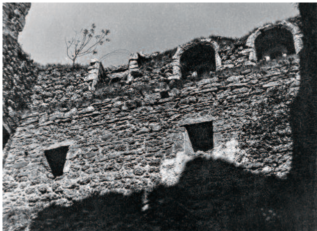
Abb. 10 Kastelen LU. Innenseite Ost, 2. und 3. Obergeschoss. Historische Aufnahme mit den weitgehend erhaltenen Fensternischen, vor 1935. Blick gegen Osten.
