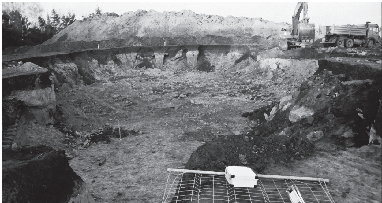
Abb. 116 FS 40, Flur »Im Steinacker«. Parzelle 18/98 nach Beendigung der Ausschachtungsarbeiten, Blick nach Norden. – (Foto RGZM).
