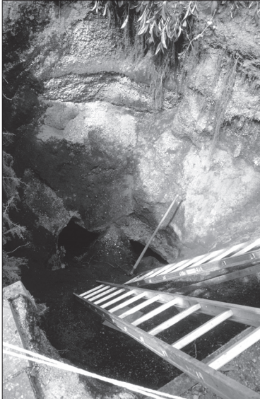
Abb. 141 FS 54, Kretzer Straße 39. Stolleneinbruch im Garten des Grundstückes. – (Foto RGZM).
