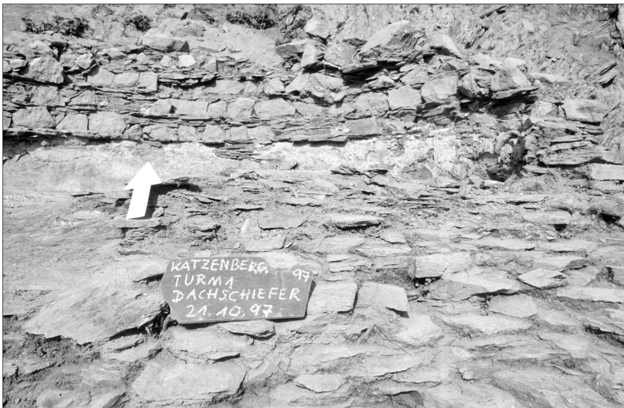
Abb. 72 Katzenberg 1997. Turm 1, abgestürztes Schieferdach.
