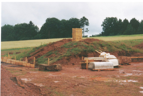
Abb. 27: Wadern-Oberlöstern, 2000. Baumaßnahme am Bodendenkmal. Mit Formen für den Nachguss der Steinquader wird experimentiert (Foto E. Jäckel).
