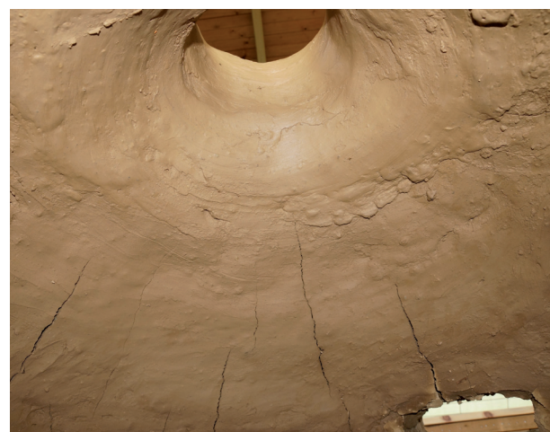
Abb. 10: Moderate radiale Trocknungsrisse im Inneren der Kuppel des Glasofens [Foto: F. Wiesenberg].
