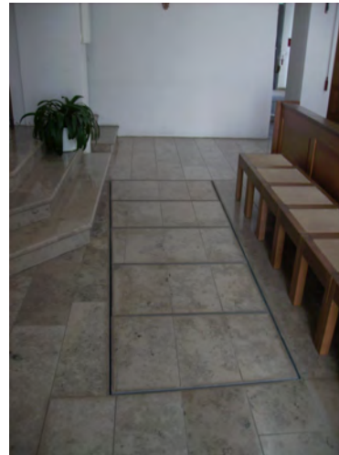
Abb. 84 Durch Platten verschlossener Abgang im Jahr 2012
