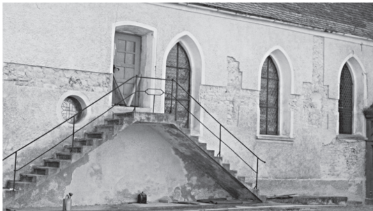
Abb. 16 Untersuchungen der südlichen Kirchaußenfassade von 1985
