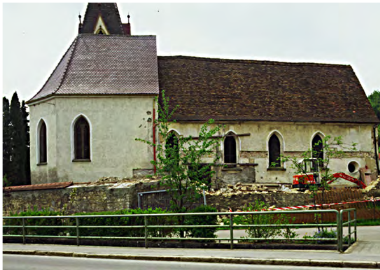
Abb. 14 Nordseite des Kirchengebäudes zu Beginn des Umbaus mit Teilabbruch der Friedhofsmauer und Teilfreilegung der Mauerstrukturen der Nordwand des Kirchenschiffs
