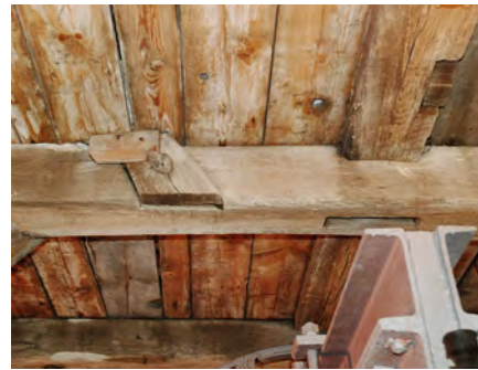
Abb. 61 Das Innere des Turmfachwerkaufsatz mit Spuren der Umgestaltung vom mechanischen Uhrenbereich zur Glockenstube im Jahr 2012
