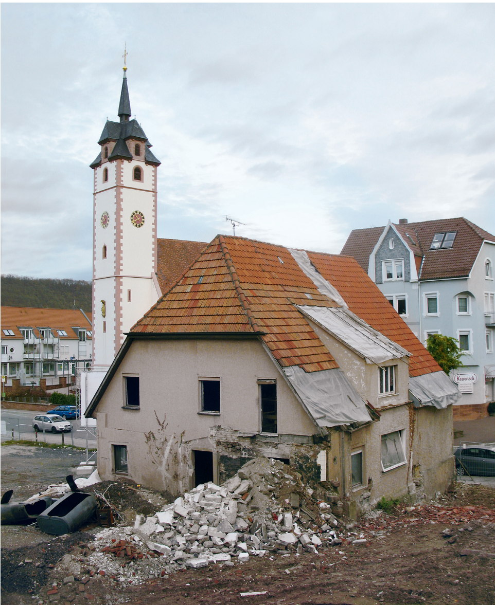
Das Haus Niefern, Hauptstraße 54, kurz vor dem Abriss. Das unscheinbare Gebäude gehörte zu den ältesten noch erhalten Profanbauten im Enzkreis.
