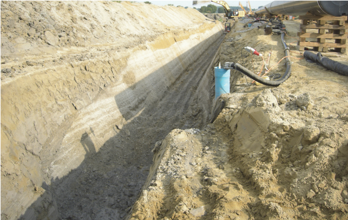
Abb. 26: Blick nach Nordwesten in den Rohrgraben im Bereich des Fundplatzes. Hier sind die fein geschichteten und durch eine Rinne im Vordergrund gekappten Terrassenablagerungen gut zu erkennen, die die Hochlage im Bereich der TM 26 verursachen.
