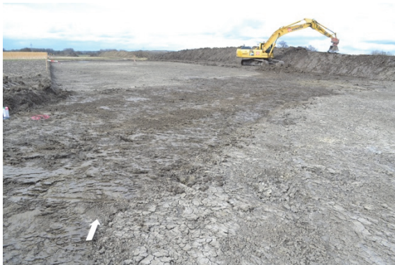
Abb. 7 Oberbodenabtrag in FlstNr. 4819, wenig südlich des Fundplatzes, Blick nach Norden (Foto Pro Arch GmbH).
