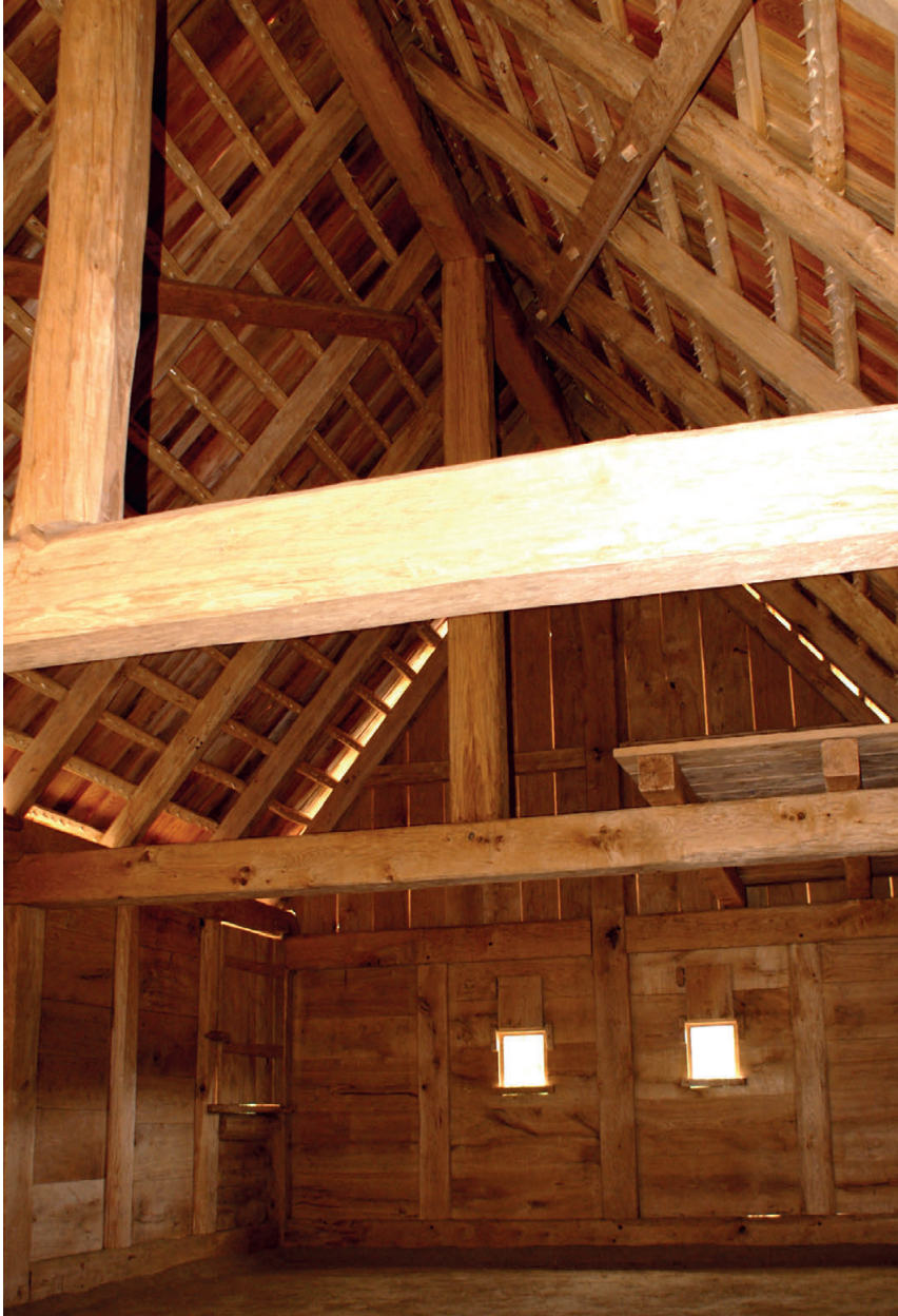
21 Keltendorf Otzenhausen, museumspädagogischer Bau. Alle Teile des in Holzbautechnik ausgeführten Gebäudes wurden unter strikter Wahrung historischer belegter Bautechniken und -materialien ausgeführt.
