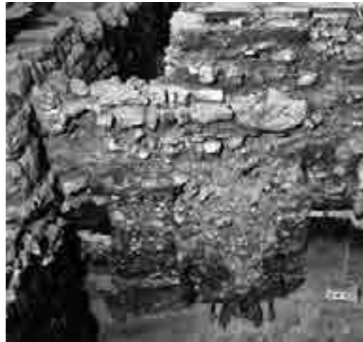
104 Schnitt 7/2, Profil 31, Südteil, von Osten. Zentral verläuft in nordsüdlicher Richtung das nachträglich an II am 2 angefügte Fundament II fm 11, welches die Erhöhung des Vorchors im Zuge der Bestattung II ib 2 anzeigt.
