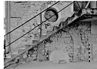
Abb. 25 Ehemalige Türelemente auf der Südseite des Kirchenschiffs von St. Vitus in Schmiechen, heute zugeputzt.
