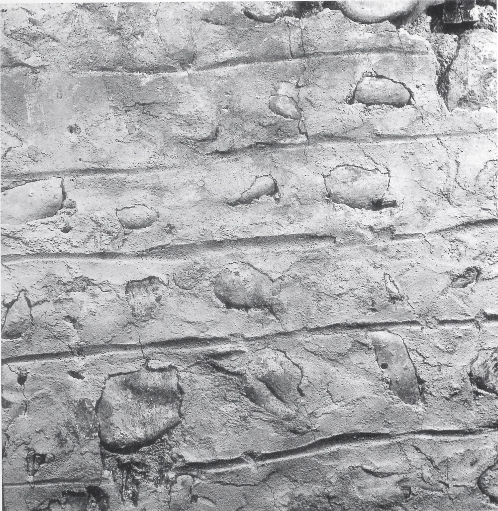
Abb. 11 Salzstr. 20; originaler Verputz im Obergeschoß des Kernbaus von 1127 (Foto Landesdenkmalamt Baden-Württemberg).
