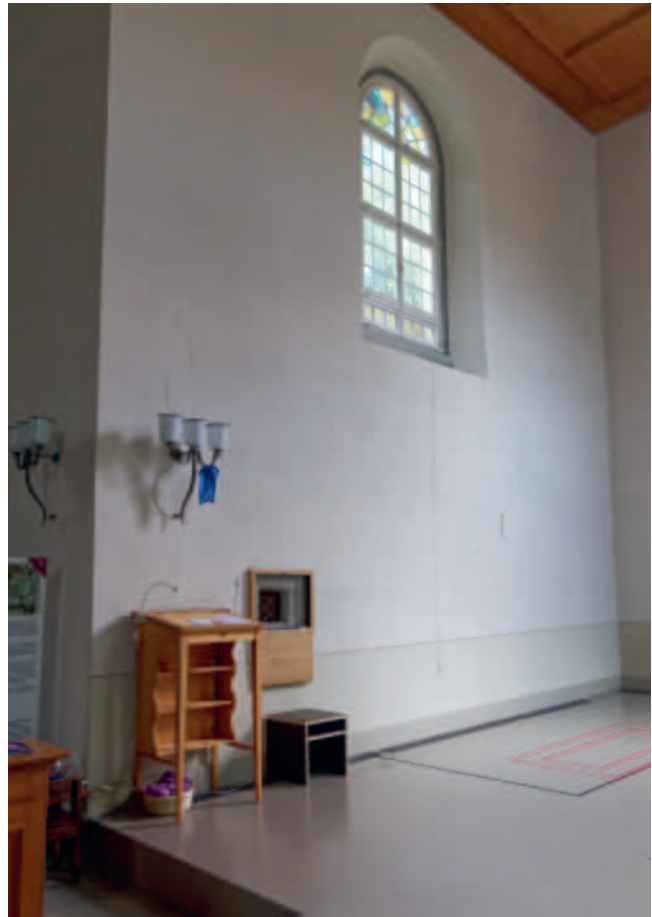
Abb. 201 Das durch die jüngste Renovierung wieder freigelegte Fenster aus der Zeit des ersten Kirchenbaus zwischen Klausur (aufgehend nicht erhalten) und dem Kirchenraum von St. Mangen (AATG 2022 Iris Hutter).
