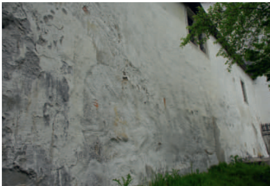
Abb. 224 Die Aussenfassade der Remise (Nebengebäude R 015) gegen Osten ist verputzt, doch erkennbar uneben (AATG 2021 Iris Hutter).
