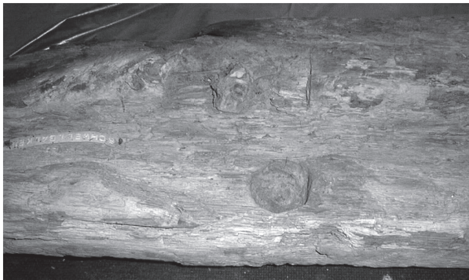
Abb. 8.14 Schwellbalken einer Fachwerkkonstruktion. Bruchstück B. Ausklüftung mit Eisennagel (vgl. Abb. 8.12g).
