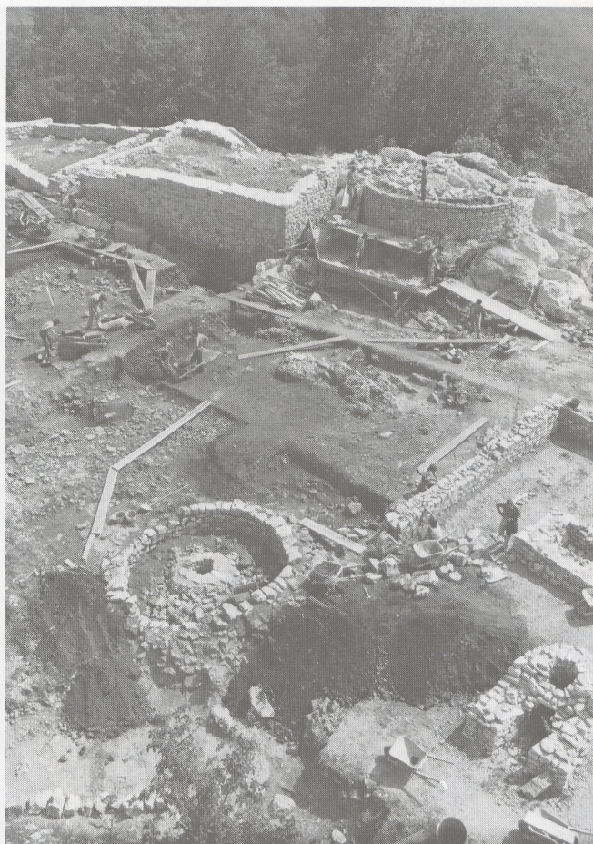
Grabungsetappe 1977. Im Hintergrund Konservierung der Bauten in Zone P, vorne die teilweise restaurierte Zisterne (Bau 13). Im mittleren Abschnitt Flächengrabung im Innenhof (Zone Z).
