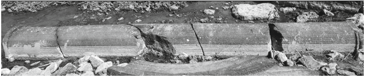
Monolithischer Säulenschaft. – Abbildung 6 (oben) Ansicht. – Abbildung 7 (unten) Klammerspur einer Reparatur. – Abbildung 8 (zu unterst) Oberes Abschlussprofil mit trapezförmiger Einarbeitung für Flickung.
