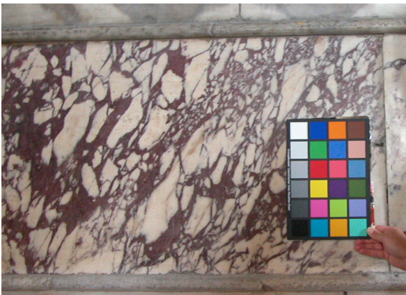
Abbildung 7.3: Mit der Aufnahme der MACBETH-Farbkarte kann die Farbigkeit und der diffuse Reflexionsgrad des Materials unabhängig von Kameraeinstellungen und Beleuchtung bestimmt werden. Schatten und Reflexionen sind zu vermeiden.
