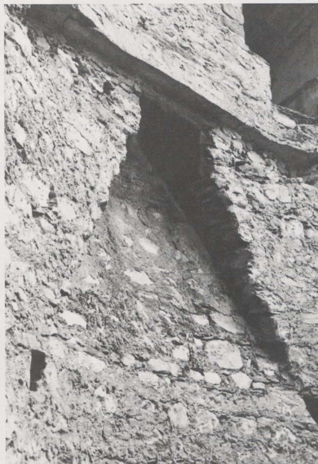
Abb. 250 Paspels/Canova, GR. Rauchabzug einer Kaminanlage mit mächtiger Kaminhaube im dritten Geschoß. Foto Kantonale Denkmalpflege Graubünden.
