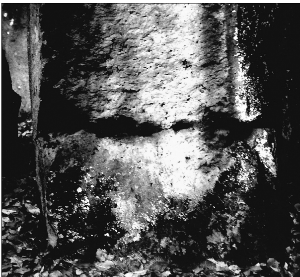
Abb. 100 Kottenheim, am Junker Schilling-Denkmal. Mißlungene Hebespaltung an einer Basaltlava-Säule in römischer Keiltaschentechnik (Typ TA).
