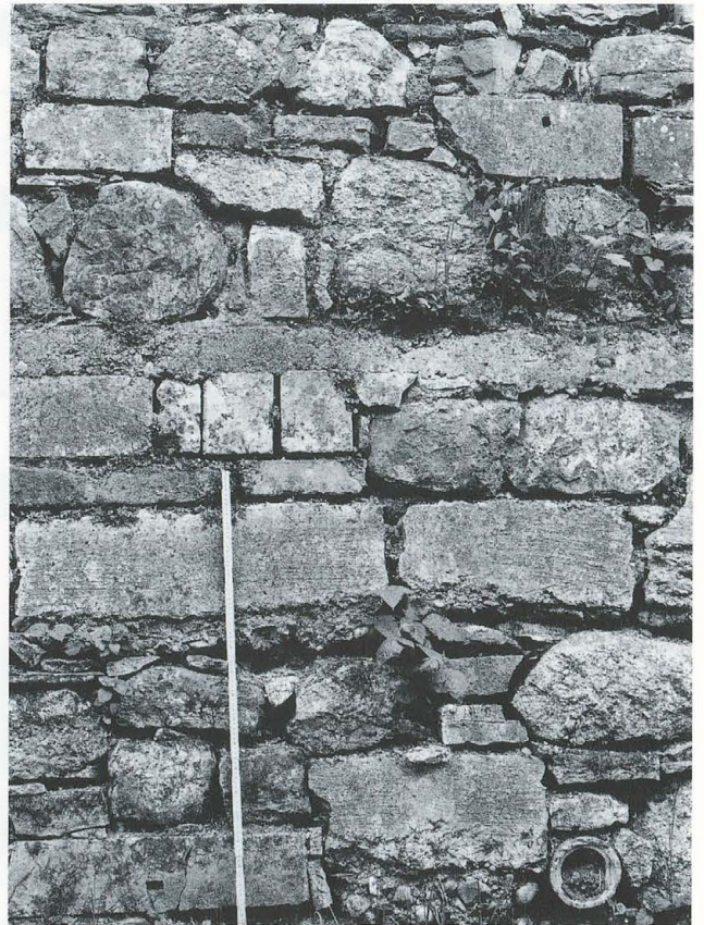
Abb. 304 Burg Zug 1976. Innere Ringmauer. Blick nach geografisch Westen. Detailansicht der inneren Ringmauer, die weitgehend aus Spolien der abgebrochenen «Mantelmauer» aufgebaut wurde.
