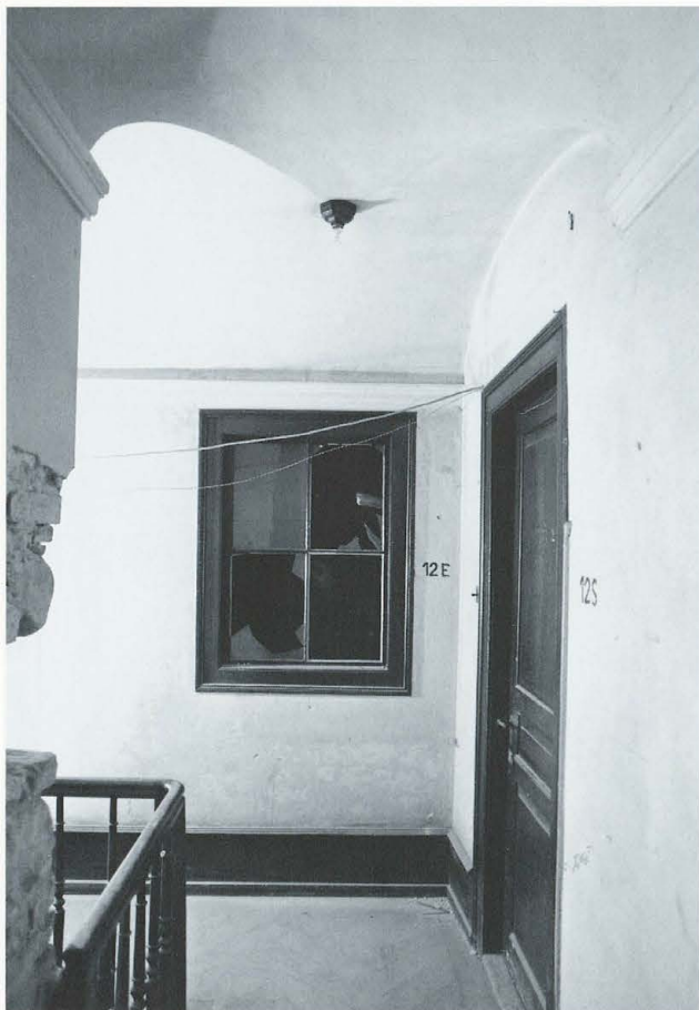
Abb. 312 Burg Zug 1975. Ostannex. Raum RN 12. Blick nach geografisch Südosten in den neuen Korridor. Die gewölbten Gipsdecken (XXV) verdecken die ursprünglich flachen Gipsdecken.
