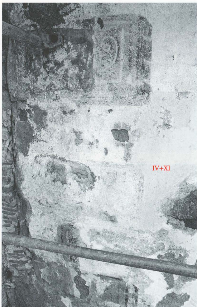
Abb. 106 Burg Zug 1979. Westfassade des Turms. Reste der originalen Eckquadermalerei im zweiten Obergeschoss.
