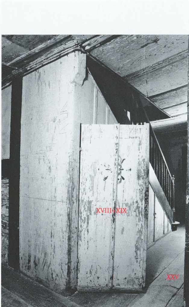
Abb. 319 Burg Zug 1975. Nordannex. Raum RN 24. Blick nach geographisch Norden. Unterbau der Treppe zum dritten Obergeschoss mit wiederverwendetem Türblatt aus Phase XVIII.
