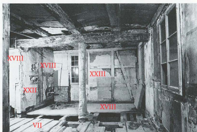
Abb. 213 Burg Zug 1978. Ostannex. Räume RN 28–30. Blick nach geografisch Nordosten. Bodenbretter aus Phase VII (vorne) und Phase XVIII (hinten). Links Abort-Einbau in Phase XVIII.
