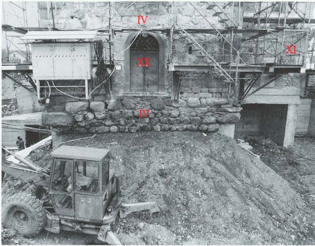
Abb. 44 Burg Zug 1980. Südfassade des Turmes mit Vorfundament, aufgehendem Mauerwerk, Mitteltüre PN 1 (XX) während der Umbauten.
