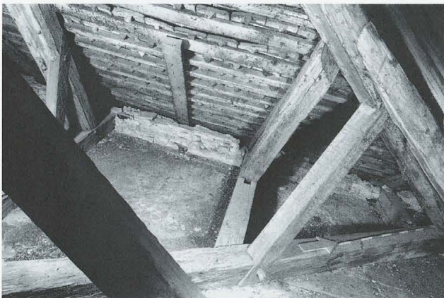
Abb. 199 Burg Zug 1978. Nordannex. Raum RN 54. Blick nach geografisch Nordwesten in das Krüppelwalmdach (XVII) mit aufgesetzten Sparren, Aufschieblingen und Streben.
