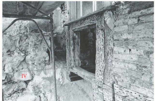
Abb. 129 Burg Zug 1979. Ostannex. Südfassade. Blick nach geografisch Nordwesten. Detail der Tür mit abgenutzter Schwelle, abgesägtem Tragbalk und eingebautem Fenster (XXII).
