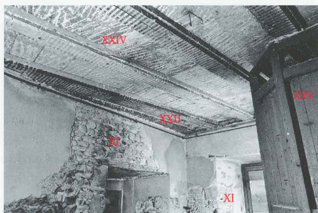
Abb. 278 Burg Zug 1978. Ostannex. Raum RN 5. Blick nach geografisch Süden. Erstmalsiger Einbau einer Balkenlage über dem Erdgeschoss im Ostannex.
