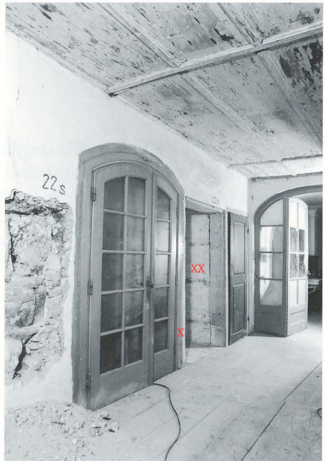
Abb. 339 Burg Zug 1975. Nordannex. Raum RN 22. Blick nach geografisch Westen. Neu eingebaute Türen zum Treppenabgang in den Turm und Korridortrenntür.
