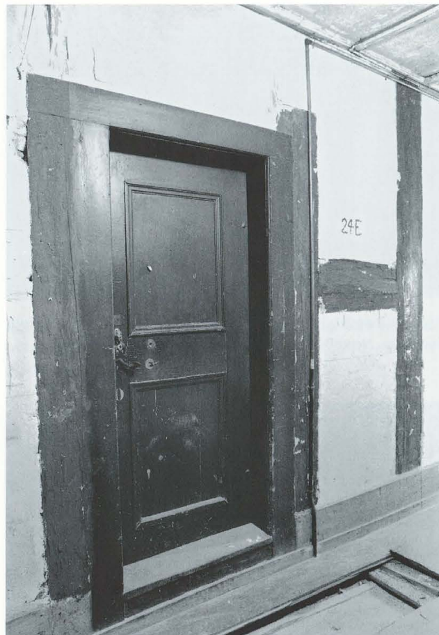
Abb. 282 Burg Zug 1975. Nordannex. Raum RN 24. Blick nach geographisch Südosten. Die Türe zum Raum RN 27 mit Futter und Verkleidung.
