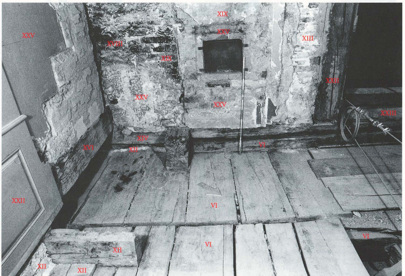
Abb. 152 Burg Zug 1978. Nordannex. Raum RN 25. Blick nach geografisch Südwesten. Links Schwelle der neu gesetzten Binnenwand (XII).
