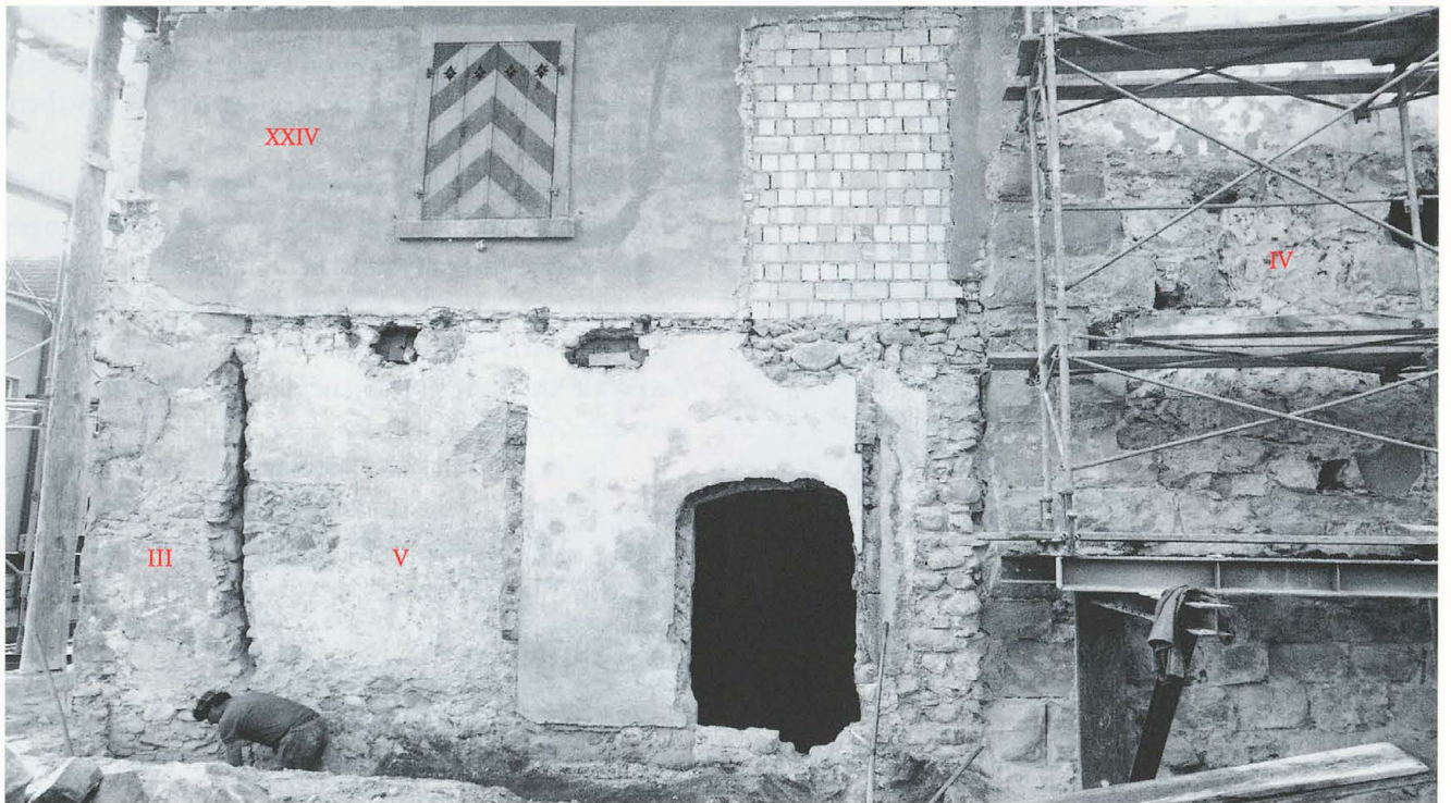
Abb. 308 Burg Zug 1979. Nordannex und Turm. Westfassade. Blick nach geografisch Südosten. Nach Abbau der Veranda (XXV) wurde im ersten Obergeschoss die neue Aufmauerung aus gelbem Lochbackstein (XXIV), im Erdgeschoss die Binnenmauer (V) und rechts das Turmmauerwerk (IV) sichtbar. Links zeichnet sich die abgebrochene «Mantelmauer» (III) ab.
