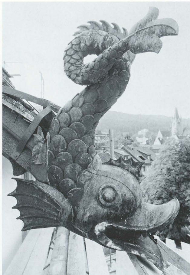
Abb. 333 Burg Zug 1981. Westfassade Turm. Der blecherne Wasserspeier aus Phase XXV.
