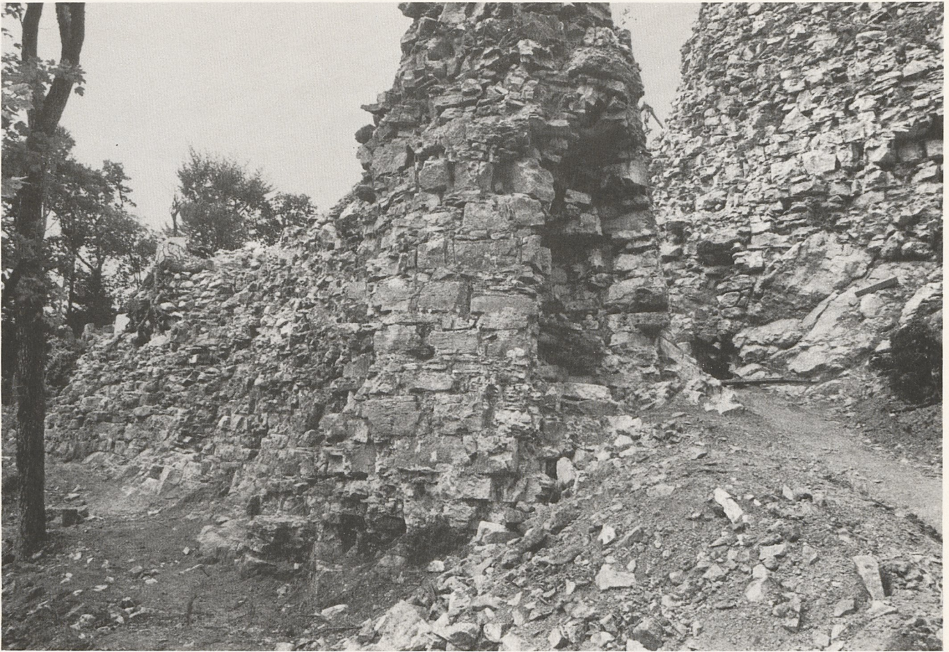
Abb.26: Der «Rundturm» am südlichen Ende der Flankenmauer 5 zeigte starke Ausbrüche. Rechts Mauer 1. Von Südwesten.
