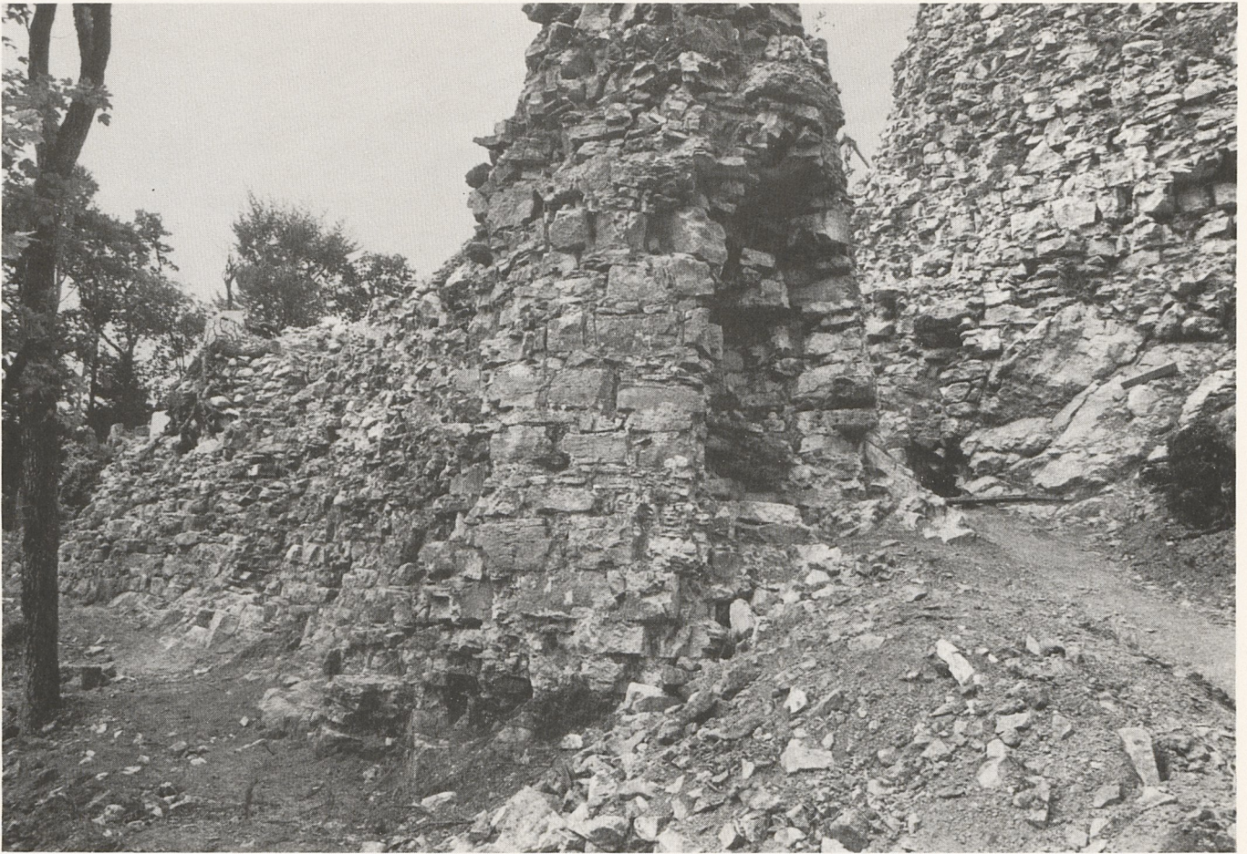
Abb.26: Der «Rundturm» am südlichen Ende der Flankenmauer 5 zeigte starke Ausbrüche. Rechts Mauer 1. Von Südwesten.
