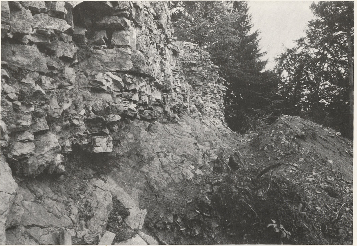
Abb. 67: Der schlechte Sitz der Fundamente von Mauer 5 auf dem steil abfallenden und verwitterten Fels machte den Ersatz der Felsfundamente notwendig.
