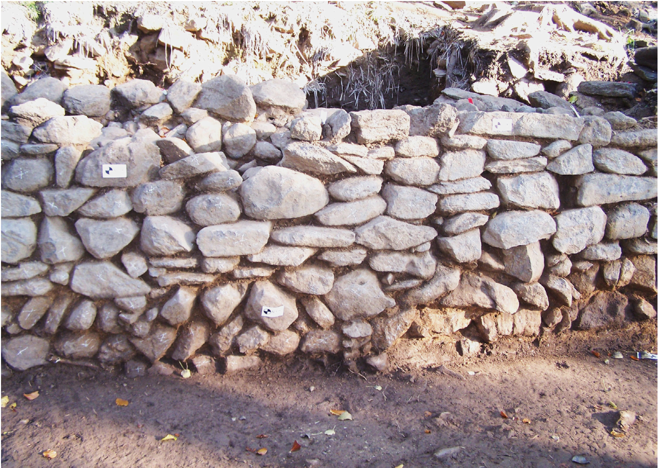
Abb. 7. Die Außenansicht der Kirchensüdmauer (Bef. 2) zeigt die heterogene Struktur des Mauerwerks (Foto: LfDH).
