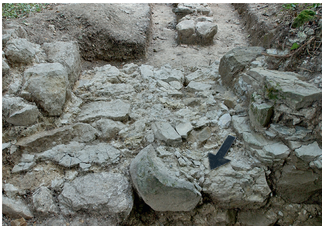
Abb. 164 Die Mauer M1/M3 ist heute mit einer Erdüberdeckung vor der weiteren Erosion geschützt. Die bei der Altgrabung dokumentierte Türöffnung war bei den Nachuntersuchungen in Sondage Sg. 10 kaum noch fassbar.
