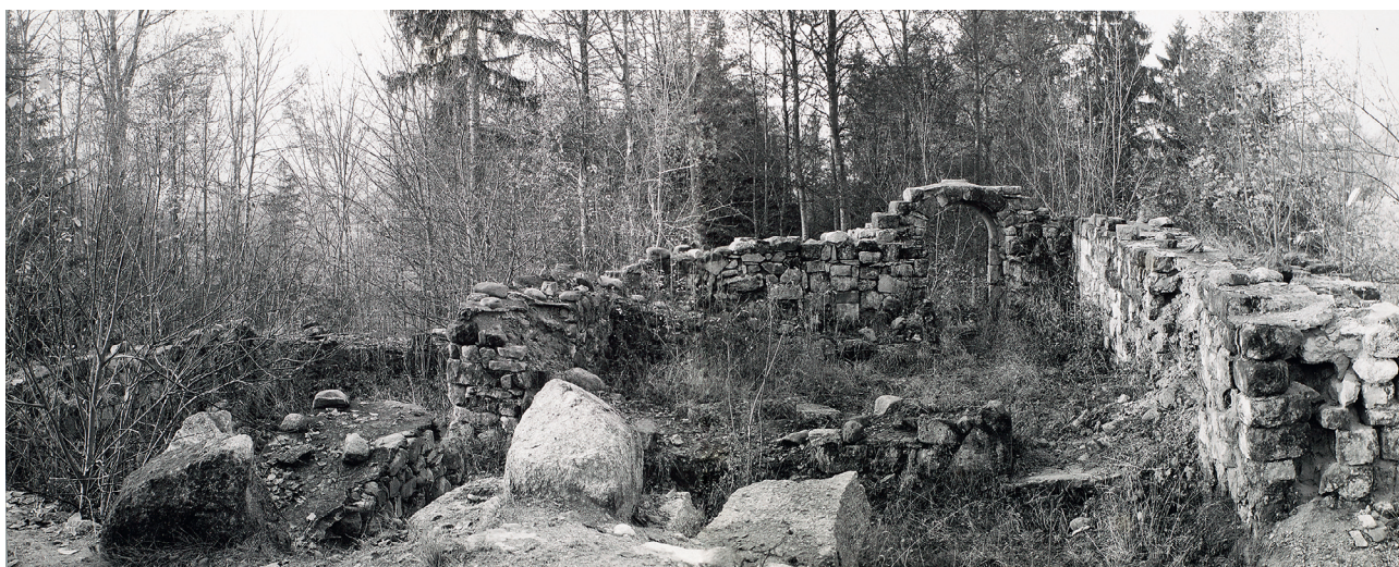
Abb. 58 Zustand der Burgruine 1959 vor der Konservierung. Die nach Abschluss der Altgrabung angebrachten Betonüberdeckungen waren grösstenteils durch Bewuchs und Witterungseinflüsse weggesprengt. Blick nach Norden in Richtung Reusstal.
