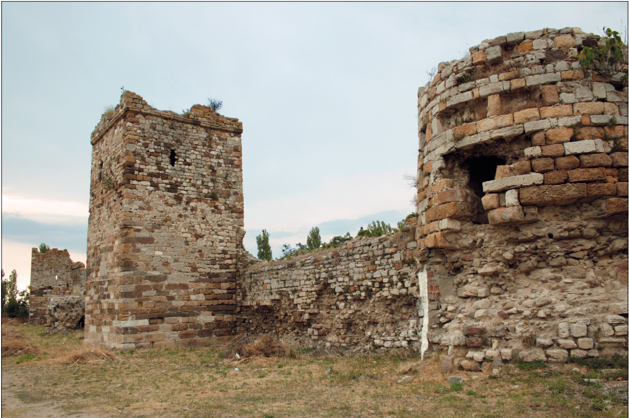
Abb. 7 Abschnitt der byzantinischen Befestigung unterhalb der Burg von Osten mit Blick auf die Türme T2 (Vordergrund) und T3. – (Foto H. Bücherl).
