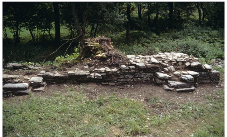
Abb. 156 Freigelegte Gewölbevorlagen, hier an der Südwand des Gebäudes, weisen darauf hin, dass die Wernsdorfer Kapelle ehemals eingewölbt gewesen ist. Bei der Mauerecke rechts handelt es sich um das Gewände des Eingangs (Foto: LWL-Archäologie für Westfalen/R. Bergmann).
