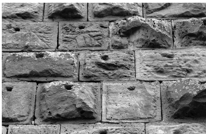
Abb. 4 Buckelquader mit Zangenlöchern am Bergfried der Oberburg – sogenannter Grüner Turm (Foto Jürgen Krüger).
