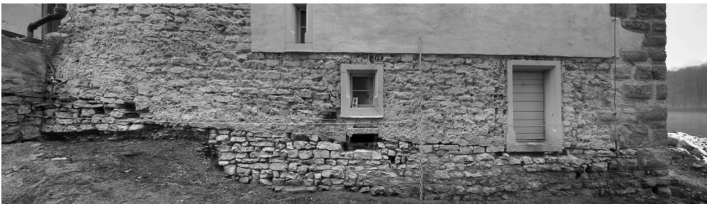
Abb. 3 Rheinfelden, Schloss Beuggen. Südwand des Alten Schlosses nach der Freilegung (RP Freiburg, Referat 26 – Denkmalpflege).
