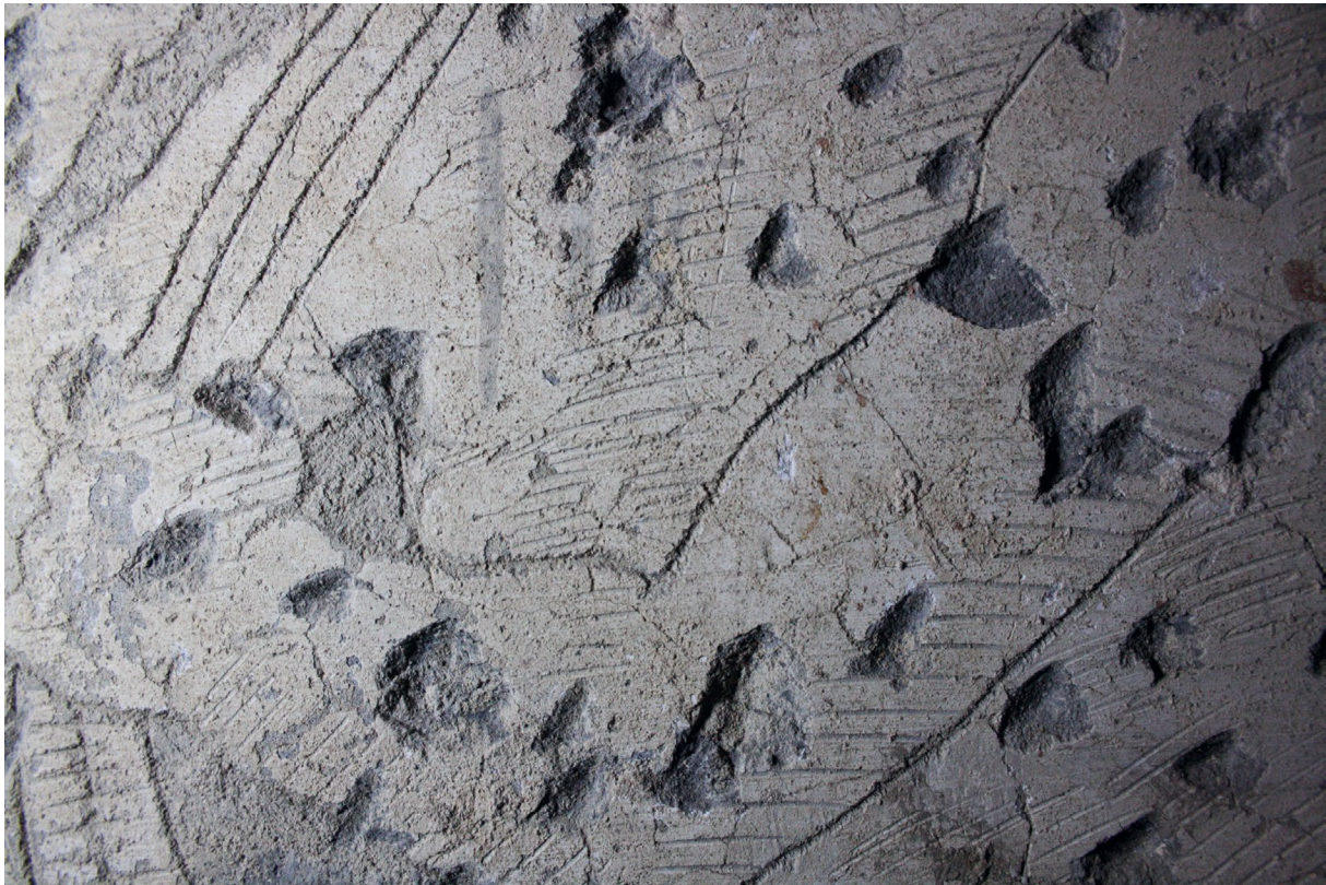
Abb. 95 Villa Sassetti/La Pietra, ehemaliger Innenhof, Südostseite, Erdgeschoss, Reste der Sgraffito-Dekoration mit Puttenfries, Detail mit Schraffuren Aufnahme 2012
