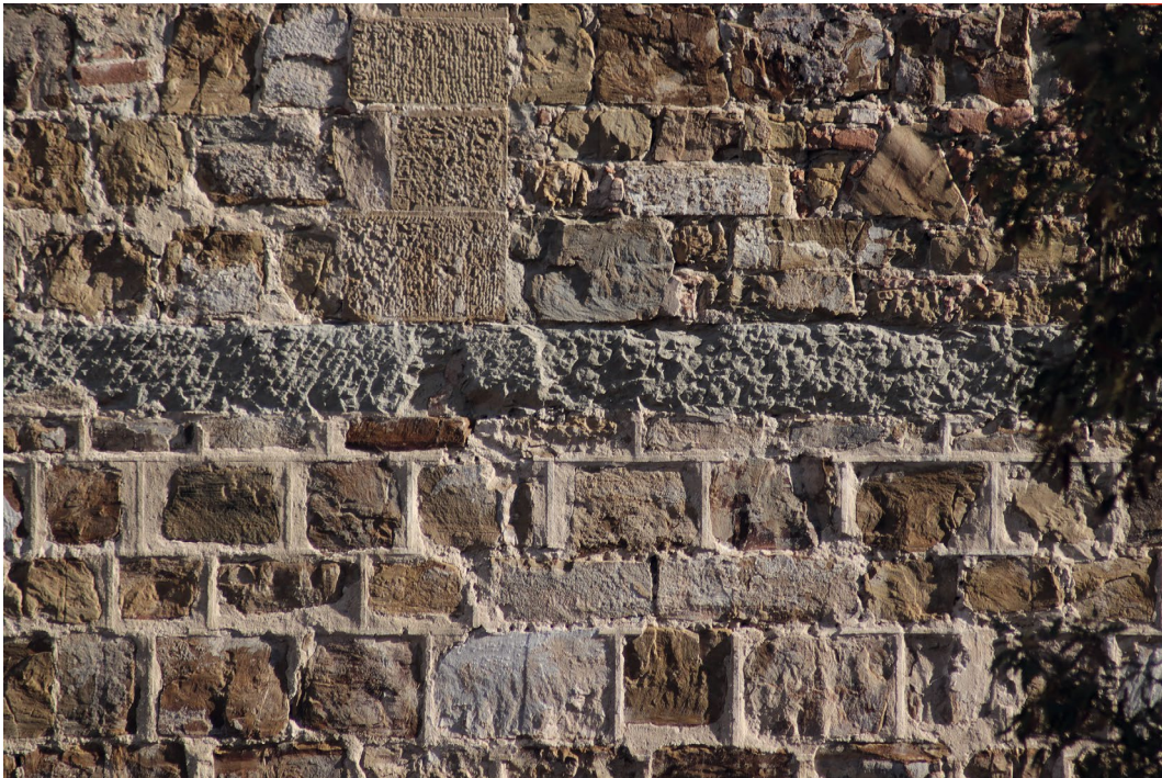
Abb. 44 Palazzo Da Uzzano, Fassade zur Via de' Bardi, 1./2. Obergeschoss, einfaches Quadermauerwerk mit Bandfugen, Aufnahme 2018
