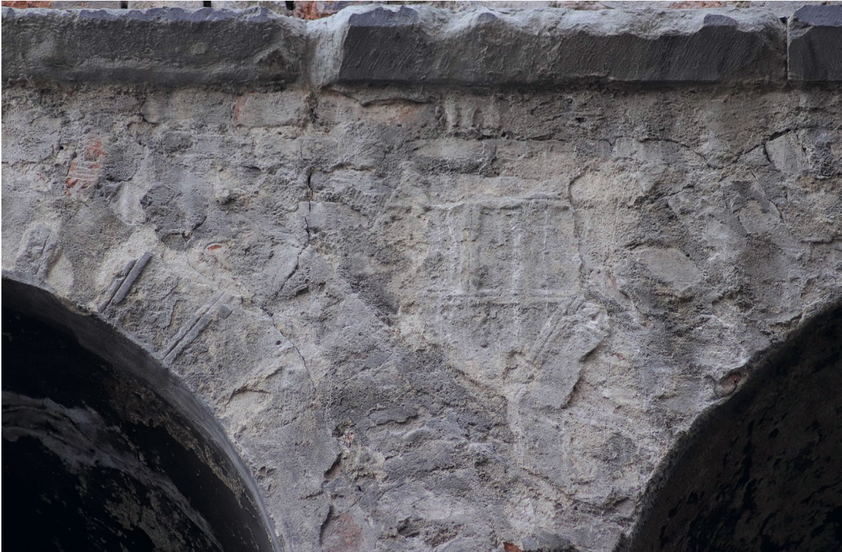
Abb. 15 Palazzo Benvenuti da Cintoia, Ost-Fassade, Wand oberhalb der beccatelli mit stark geschädigter/verlorener Sgraffito-Dekoration, Aufnahme 2018
