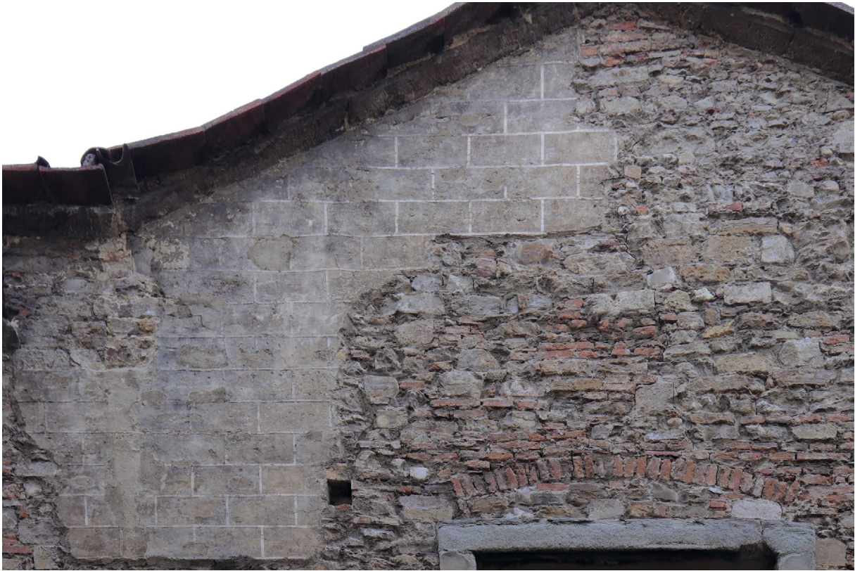
Abb.2 San Remigio, Chorfassade, Reste der Sgraffito-Dekoration, Aufnahme 2018
