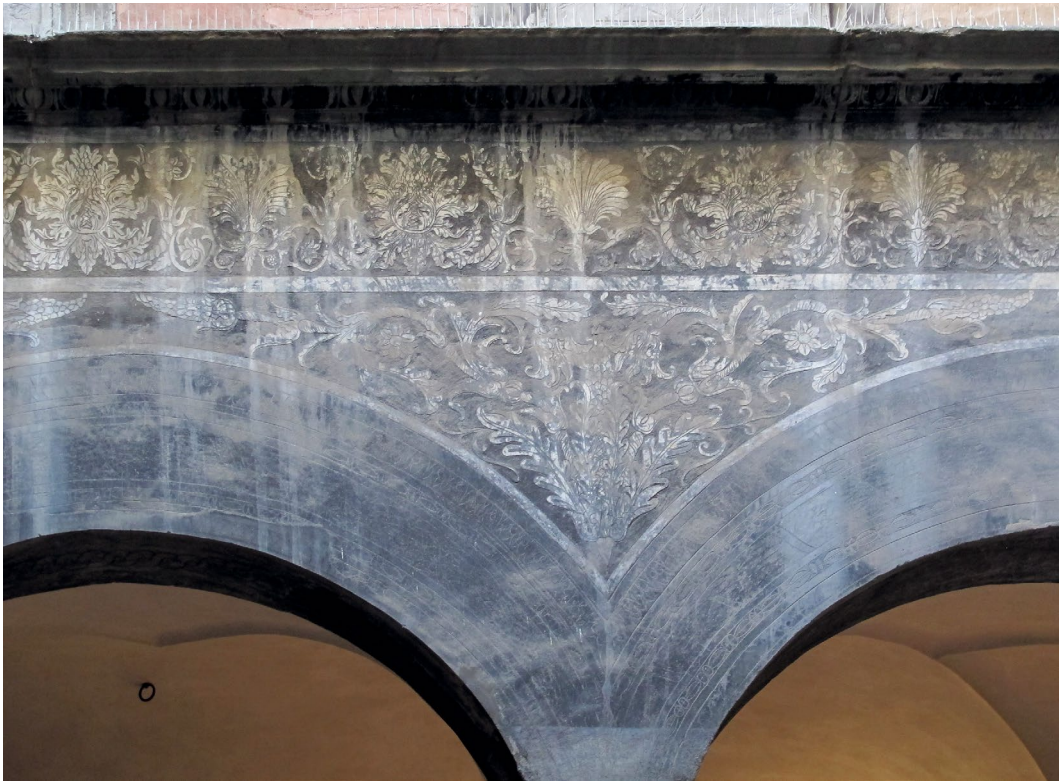
Abb. 85 Palazzo Spinelli, Innenhof, Erdgeschoss, Arkade, Sgraffito-Dekoration auf Zwickel und Fries (restauriert), Aufnahme 2014
