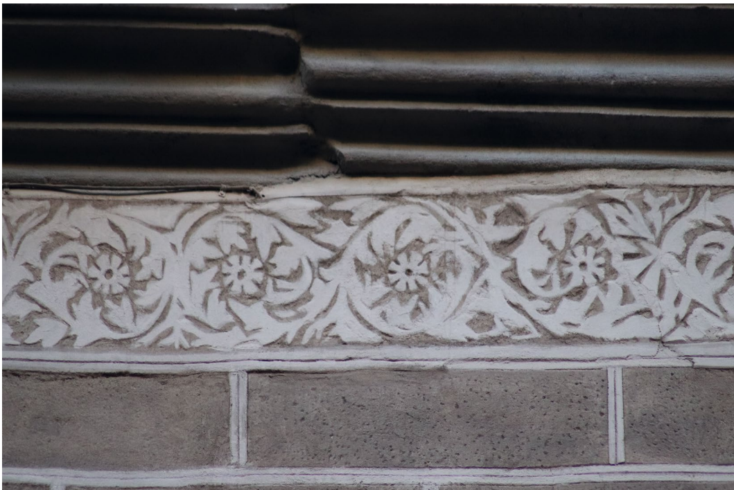
Abb. 113 Palazzo Corbinelli, Fassade zur Via Maggio, 1. Obergeschoss, Sgraffito-Dekoration (zum Teil rekonstruiert, restauriert), Fries unterhalb des Macigno -Gesimses, Aufnahme 2022
