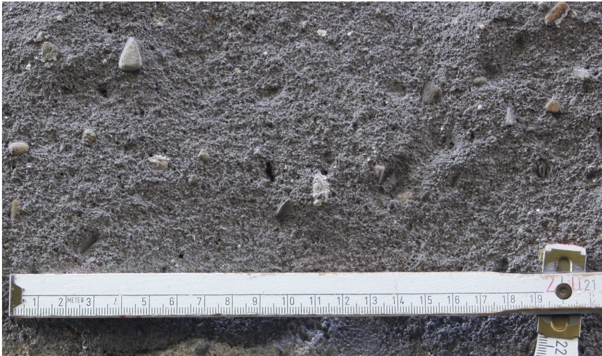
Abb. 110 Palazzo Spinelli, Fassade zum Borgo Santa Croce, Erdgeschoss, gefärbter Putz (möglicherweise nicht bauzeitlich) mit Kalkklumpen und Schwarzpigment, Aufnahme 2014
