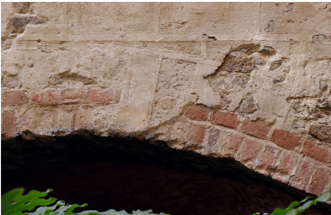
Abb. 11 Santa Croce, Arkadengang vor der Sakristei, Erdgeschoss, Fassade zum Chiostro antico, Arkadenbogen, Sgraffito-Dekoration mit stark geschädigten und verlorenen Bereichen, Aufnahme 2018
