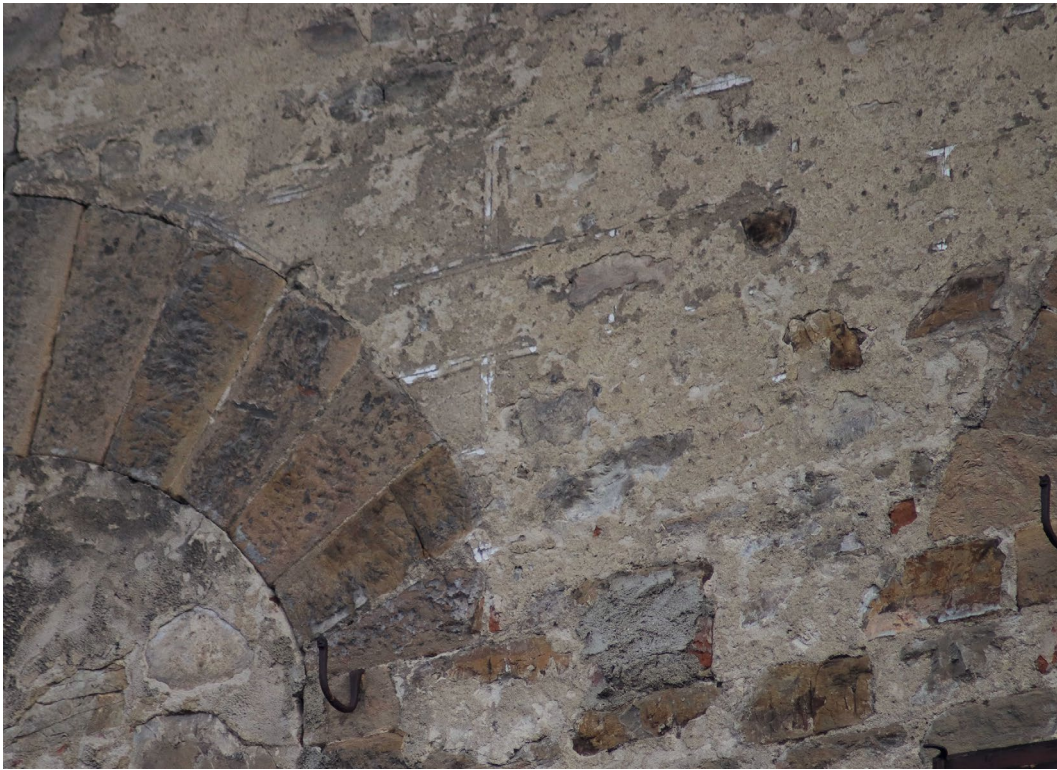
Abb. 10 Palazzo Benvenuti da Cintoia, Süd-Fassade, Reste der Sgraffito-Dekoration mit starker Schädigung der Oberfläche, Aufnahme 2018
