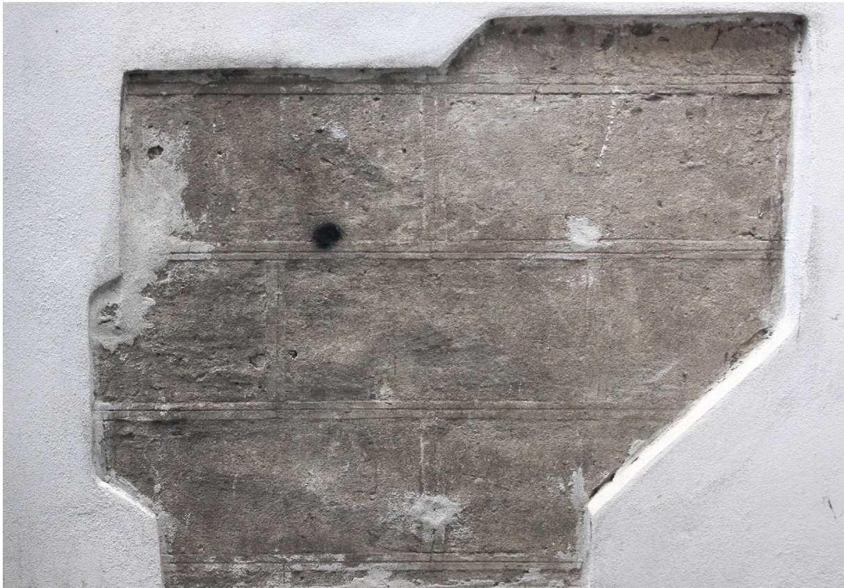
Abb. 164 Palazzo Giandonati, südliche Gebäudeseite (von Palazzo Canacci verdeckt), 2. Obergeschoss, Befundfreilegung mit Fragment der bauzeitlichen Sgraffito-Dekoration, Aufnahme 2016
