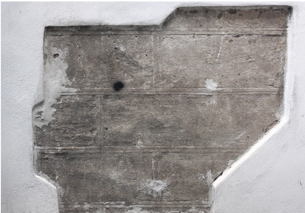
Abb. 57 Palazzo Giandonati, südliche Gebäudeseite (von Palazzo Canacci verdeckt), 2. Obergeschoss, Befundfreilegung mit Fragment der bauzeitlichen Sgraffito-Dekoration, Aufnahme 2016
