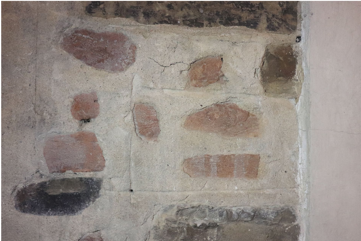
Abb. 40 Santa Croce, Gebäudeflügel zwischen Sakristei und Cappella Pazzi, ehem. Außenseite (heute in der Cappella del Noviziato), verfugtes unregelmäßiges Mauerwerk mit Kellenstrich, Aufnahme 2018
