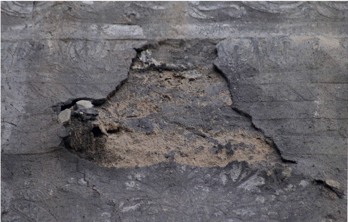
Abb. 13 Palazzo Spinelli, Fassade zum Borgo Santa Croce, 1. Obergeschoss, Sgraffito-Dekoration (Anfang des 20. Jahrhunderts restauriert) mit Schäden und Verlusten, Aufnahme 2018
