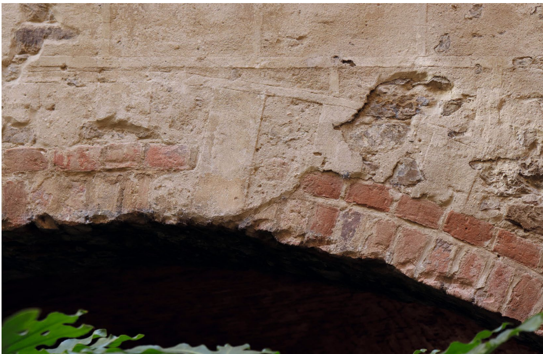
Abb. 11 Santa Croce, Arkadengang vor der Sakristei, Erdgeschoss, Fassade zum Chiostro antico, Arkadenbogen, Sgraffito-Dekoration mit stark geschädigten und verlorenen Bereichen, Aufnahme 2018
