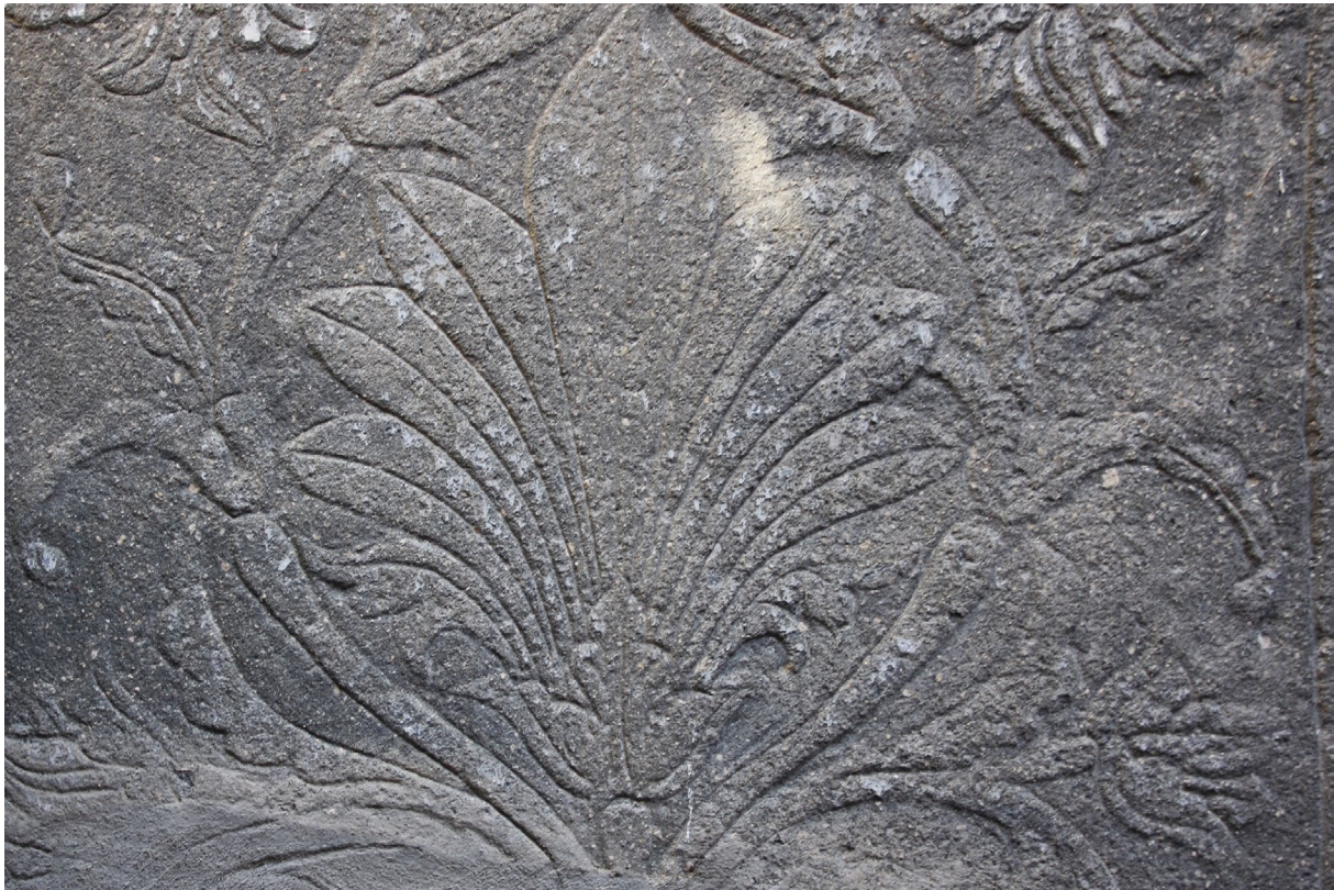
Abb. 14 Palazzo Spinelli, Innenhof, 1. Obergeschoss, Sgraffito-Dekoration mit geschädigter Oberfläche, Aufnahme 2018
