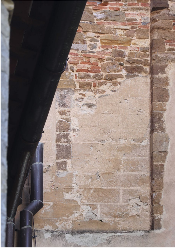
Abb. 12 Santa Croce, Cappella Castellani, Giebel mit Resten der Sgraffito-Dekoration, Aufnahme 2019
