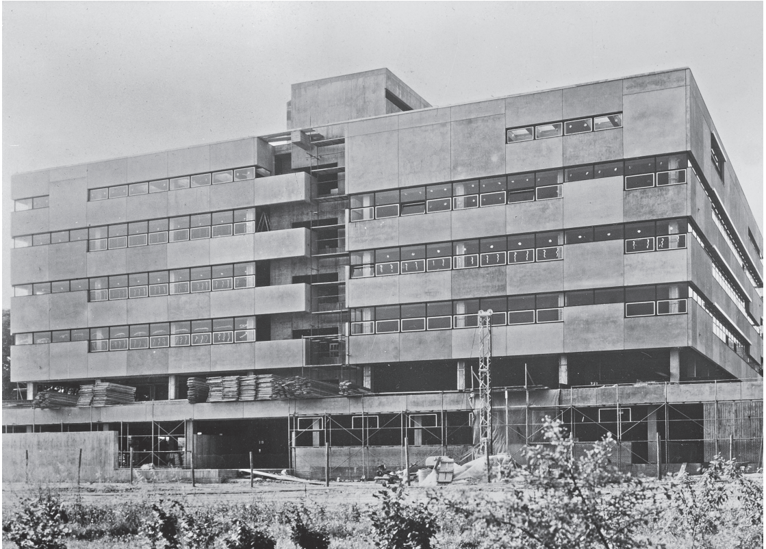
Abbildung 13 Architekturgebäude der TU Darmstadt im Bau, ca. 1968, Foto: Unbekannt, Glasdia-Sammlung Fachgebiet Architektur- und Kunstgeschichte, TU Darmstadt.
