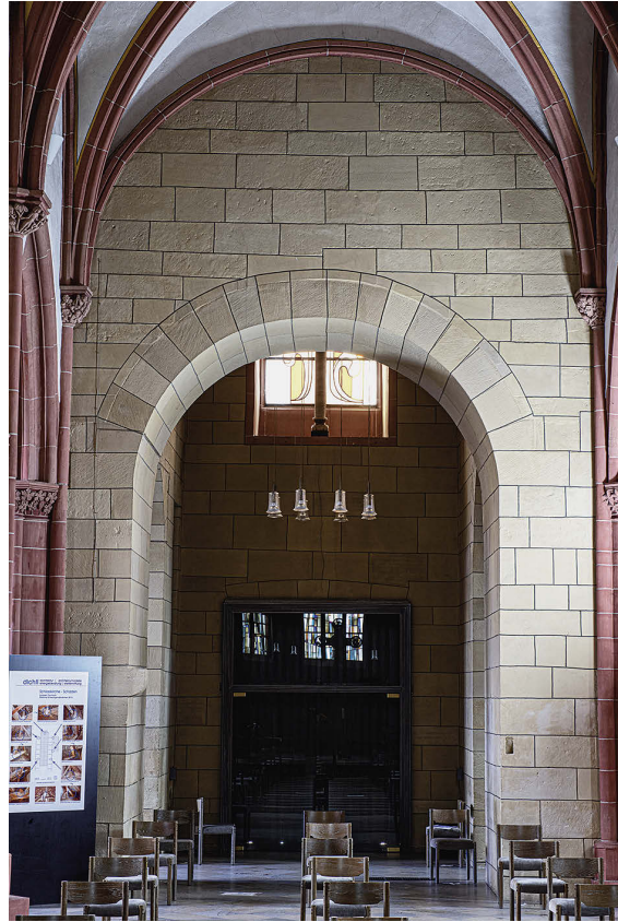
9 Blick vom Hauptschiff nach Westen durch den 1978 ganz geöffnete Bogen zur Turmhalle. Der Abstand vom Bogengewände zum Arkadenpfeiler ist im Süden geringer, als im Norden.
