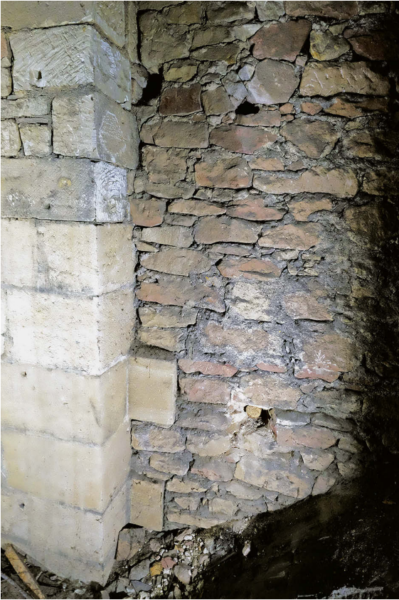
8 Turmanschluss im südlichen Seitenschiffdachraum, Blick von Süden: Das Bruchsteinmauerwerk des Obergadens, rechts im Bild, trifft etwas versetzt auf das Quadermauerwerk des Turms. Die Verzahnung wurde sorgfältig darauf abgestimmt.
