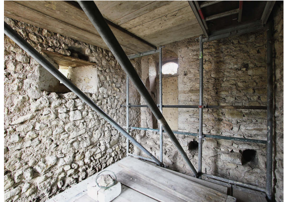
15 Turminneres auf Höhe des Wehrgangs. Rechts im Bild die bauzeitlichen Balkenlöcher einer Decke; links eine nachträglich eingebrochene Schießcharte; im Hintergrund der östliche, vermauerte Durchgang auf den Wehrgang (Foto 2018).
