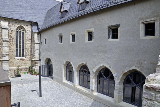
3 Kirche und Klausurflügel nach der Instandsetzung mit den wieder freigelegten Arkaden. Blick von Südwesten (Foto 2016).
