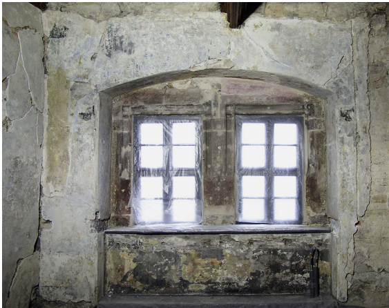
14 Klausurflügel, Obergeschoss, südliche Bohlenstube. Links die sekundär eingebaute Trennwand der Bauphase 3; im oberen Wanddrittel zieht der Wandputz der Bauphase 2 hinter die Trennwand. Blick von Westen (Foto 2017).
