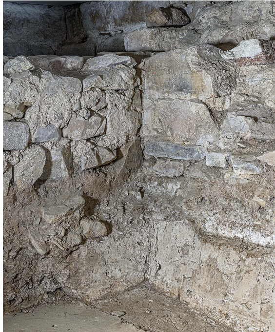
19 Das Mauerwerk (II fm+am 10, links) stößt stumpf gegen das Chorbogenfundament (II fm 2, rechts), Blick von Südwesten.
