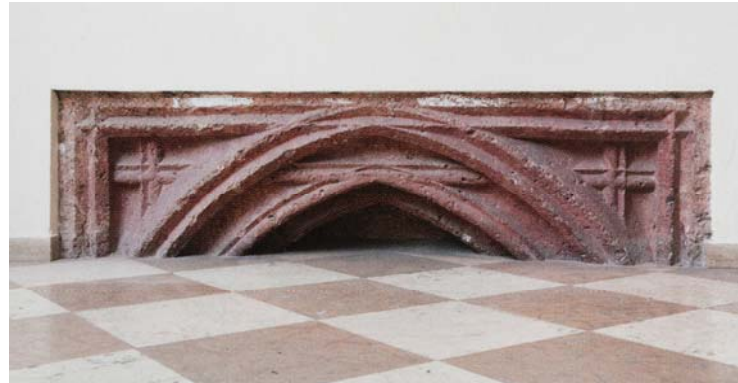
Abb. 12 Innsbruck, Hofburg, Frauenzimmerbau, 1. OG, Mittelflur, Westseite, Portalfragment.
