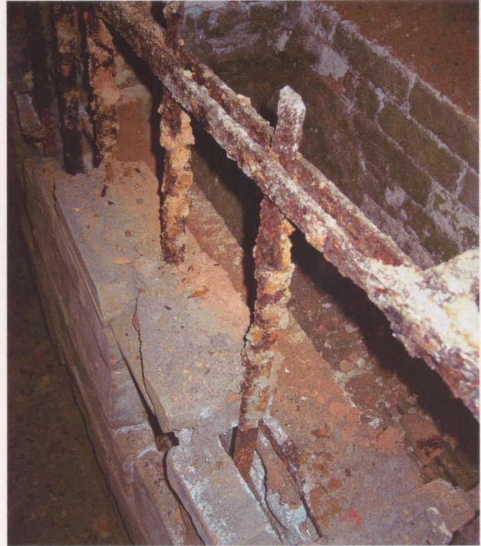
Abb. 14 Eisenkorsett um die Feuerung von Kachelofen Nr. 7
