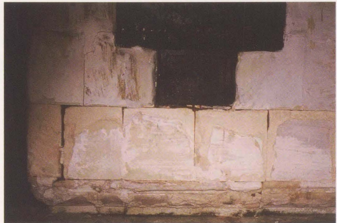
Abb. 4 Absprengungen durch Frostschaden und Ausblühungen, Küchenofen, Bayreuth, Eremitage
