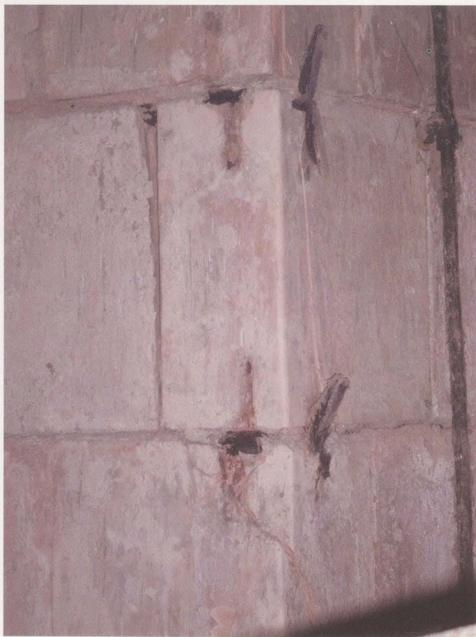
Abb. 15 An den Kachelecken sind die umgebogenen Enden der Zugeisen sichtbar, teilweise abgerostet und heruntergefallen
