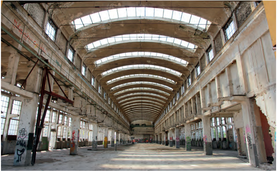
Abb. 2: Verfall und Raumwirkung. Die leerstehende Betriebshalle der IBAG in Neustadt an der Weinstraße (2015)
