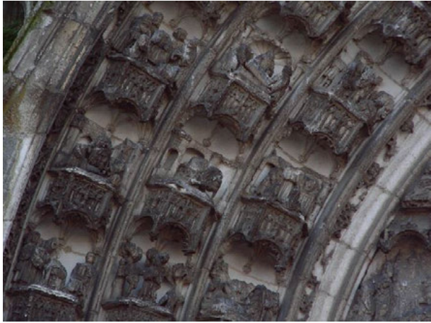
Abb. 116: Stark beschädigte Archivolten des Germanusportals
