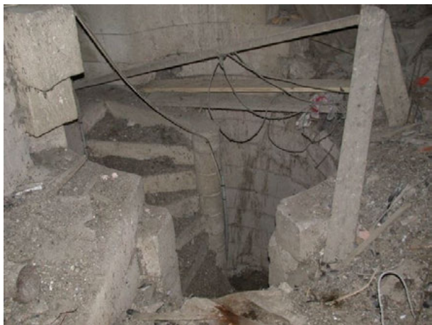
Abb. 98: Südturm, unvollendete Treppenspindel
