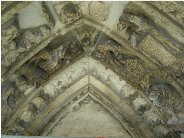
Abb. 107: Beschädigte Archivolten des Marienportals
